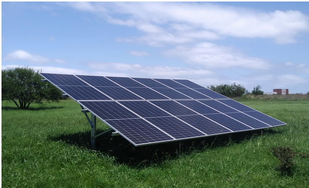
Figura 1 – Painel fotovoltaico estudado.
