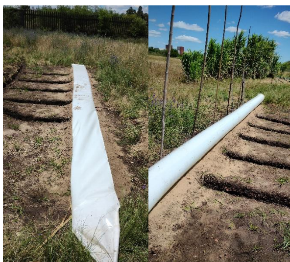
Figura 16: Instalação do politubo (a) seguido de enchimento inicial do politubo sem pressão(b). O autor.
