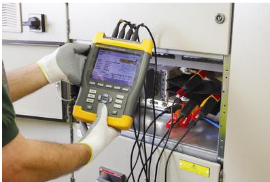
Figura 6. Medidor de qualidade da energia elétrica sendo utilizado.
