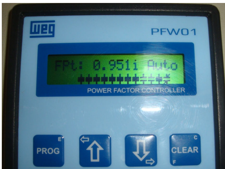
Figura 19: Mostrador de FP do quadro de compensadora subestação 4.
