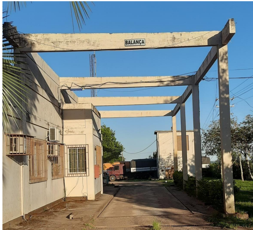
Figura 8 – Balança para a pesagem dos caminhões
