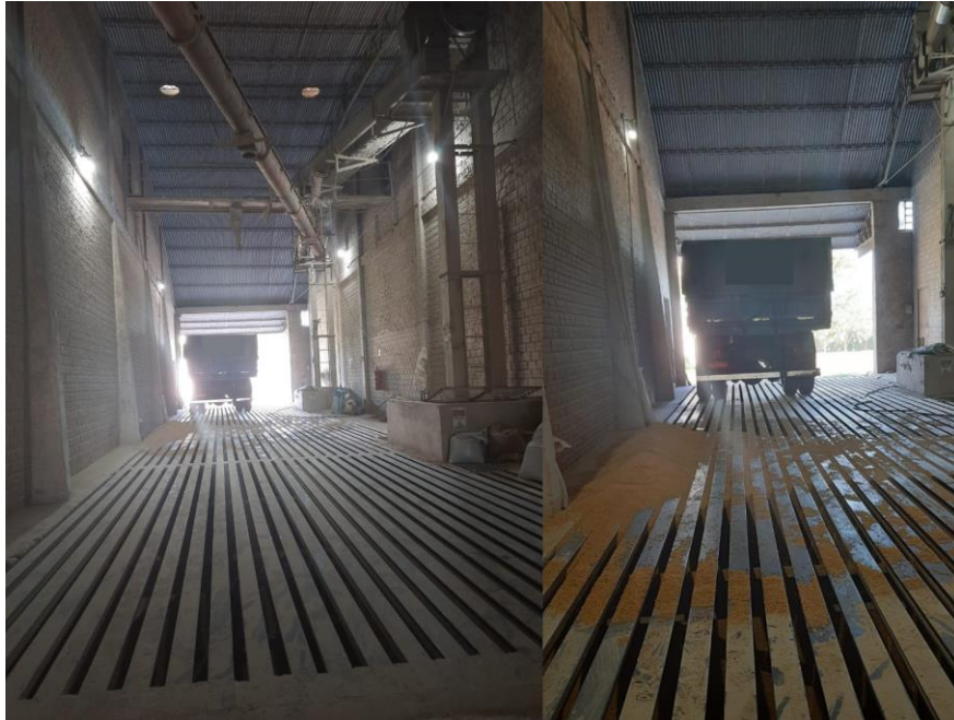
Figura 9 – Moega para o descarregamento de grãos
