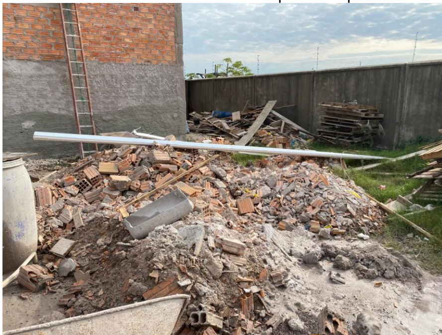
Figura 24 – Resíduos de diferentes classes espalhados pelo canteiro de obra
