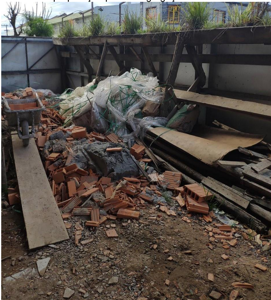
Figura 25 – Obra sem preparação para a segregação e armazenamento adequados
