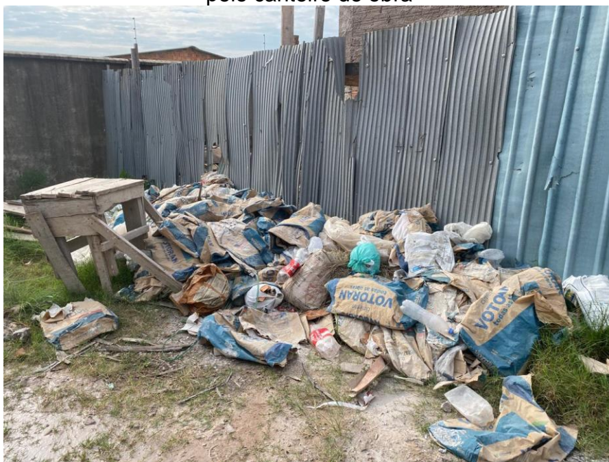
Figura 23 – Embalagens de papel com materiais cimentícios (classe C) espalhados pelo canteiro de obra
