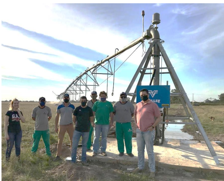
Figura 6 Finalização da instalação do pivô central da irrigação na Área Experimental do Campus Itaqui da UNIPAMPA
