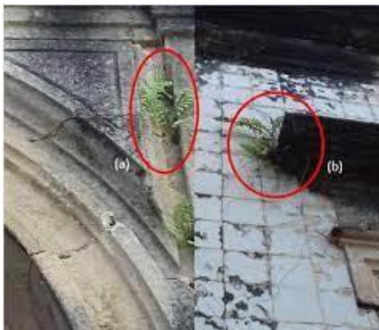
Figura 7 – Vegetação crescendo na fachada
