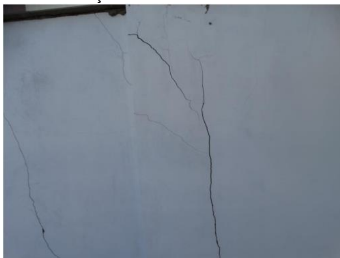
Figura 1 – Detalhe de fissuração
