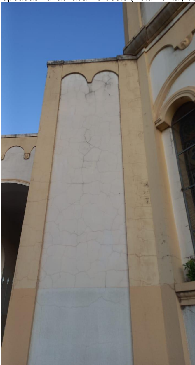
Figura 17 - Fissuras mapeadas na fachada Nordeste (vista frontal) da edificação
