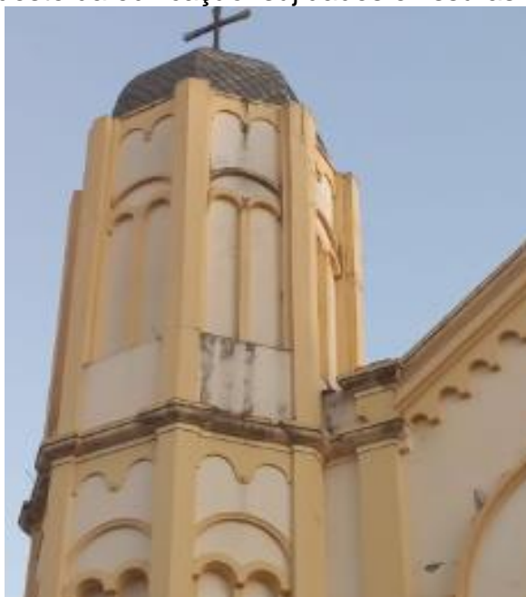
Figura 15 - Fachada Nordeste da edificação: sujidades e fissuras.
