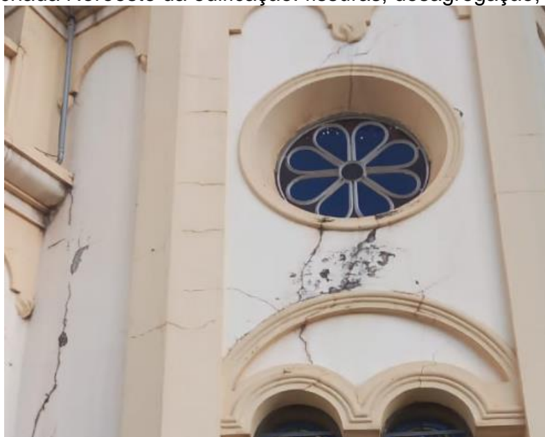
Figura 25 - Fachada Noroeste da edificação: fissuras, desagregação, mofo e bolor.
