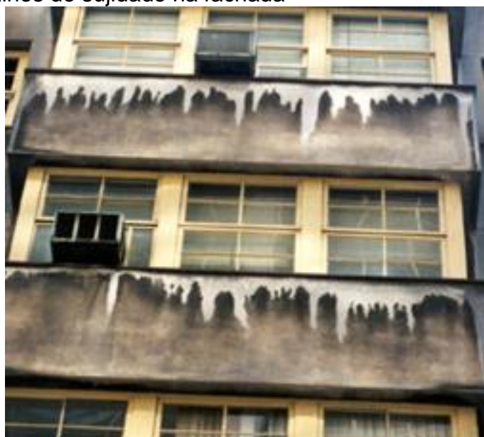
Figura 5 – Detalhes de sujidade na fachada
