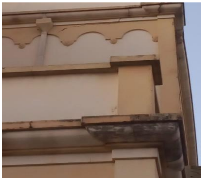
Figura 21 - Fissuras e sujidades na fachada Sudeste.
