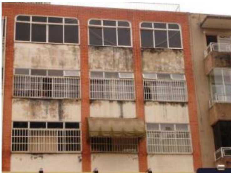
Figura 4 – Manchas de bolor ou mofo em uma fachada
