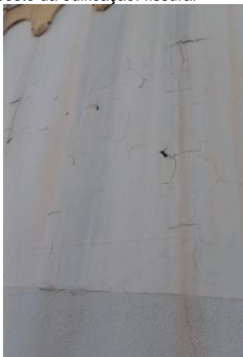
Figura 20 - Fachada sudoeste da edificação: fissura.
