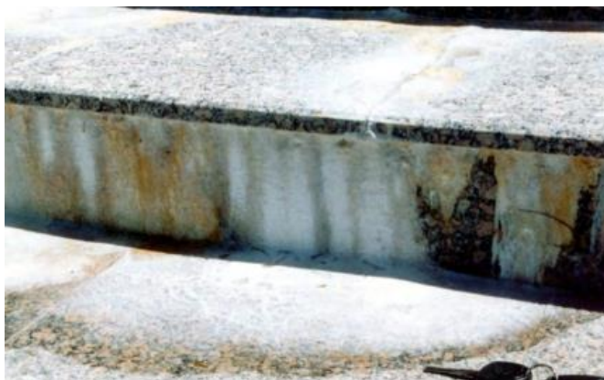
Figura 2 – Manifestação de eflorescência em revestimento argamassado e azulejado
