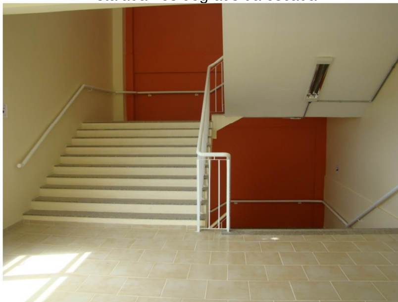
Figura 9 - Revestimento cerâmico instalado no piso do patamar e pedra natural instalada nos degraus da escada.
