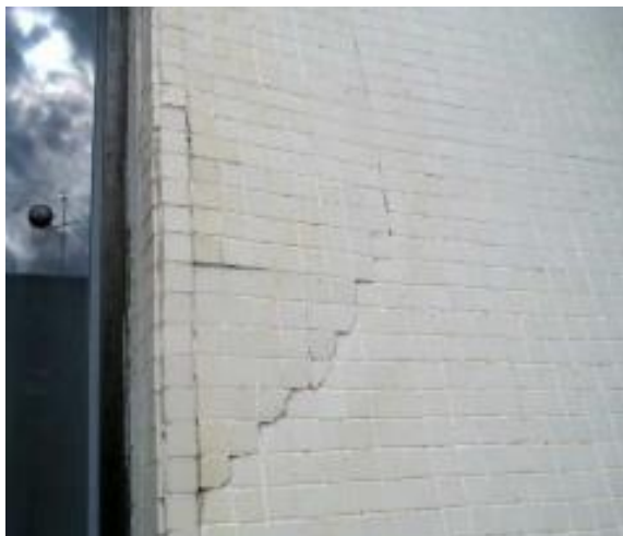
Figura 7 – Descolamento Localizado em Revestimento Cerâmico
