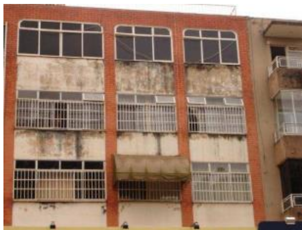
Figura 9 – Manchas de Bolor ou Mofo na Fachada
