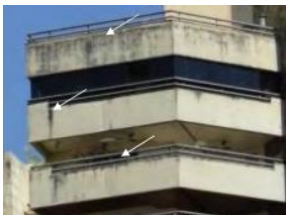
Figura 10 – Manchas de Sujidade abaixo de peitoris em edifício na cidade de Goiânia
