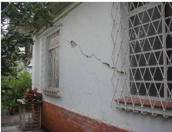
Figura 3 – Revestimento de fachada com fissuras e trincas
