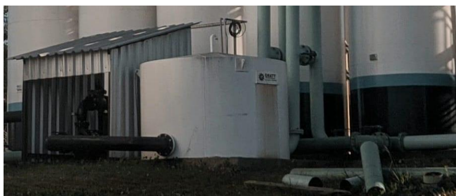
Figura 22 – Reservatório para cloração.
