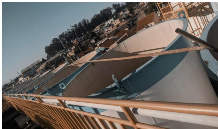
Figura 21 – Tanques de Filtração
