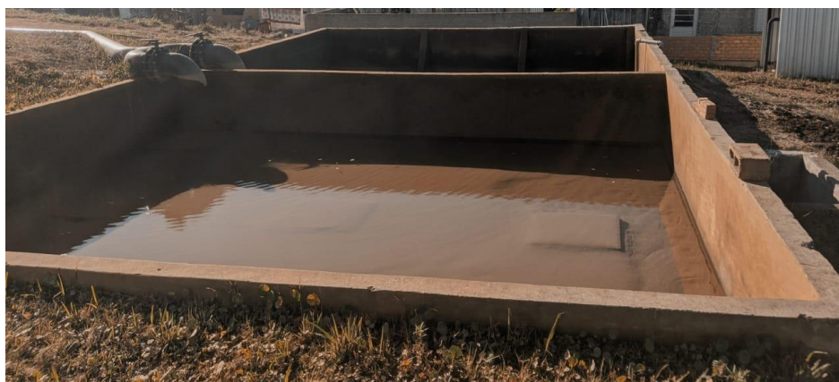
Figura 24 – Reservatório de armazenamento da água da lavagem de filtros
