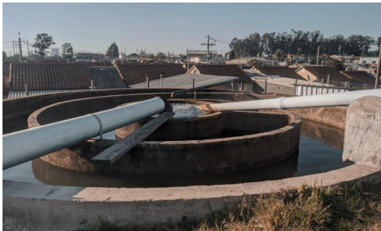
Figura 19 – Armazenamento de água bruta
