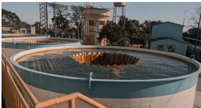
Figura 20 – Tanques de floculação e sedimentação
