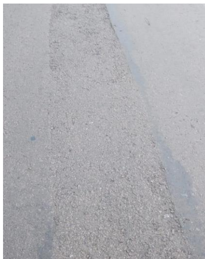
Figura 26 - Remendo encontrado na via.
