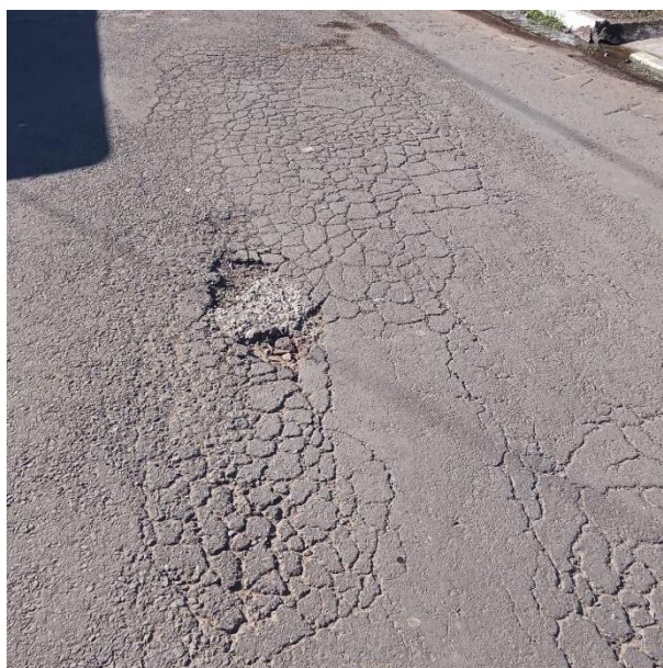
Figura 34 - Panela e Trincas interligadas do tipo "Couro de Jacaré" encontrados na via.
