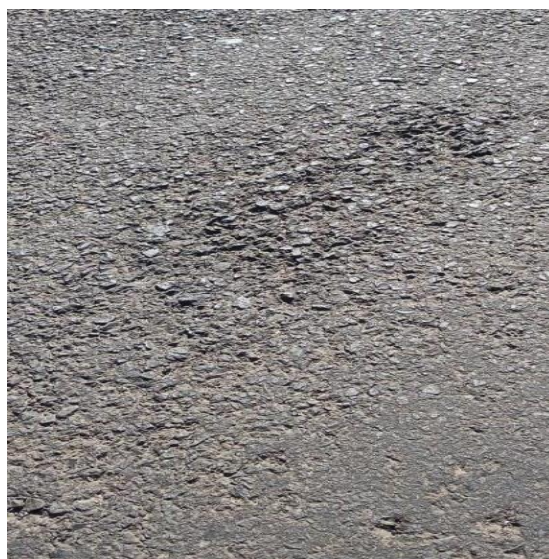
Figura 39 - Desgaste encontrado na via.
