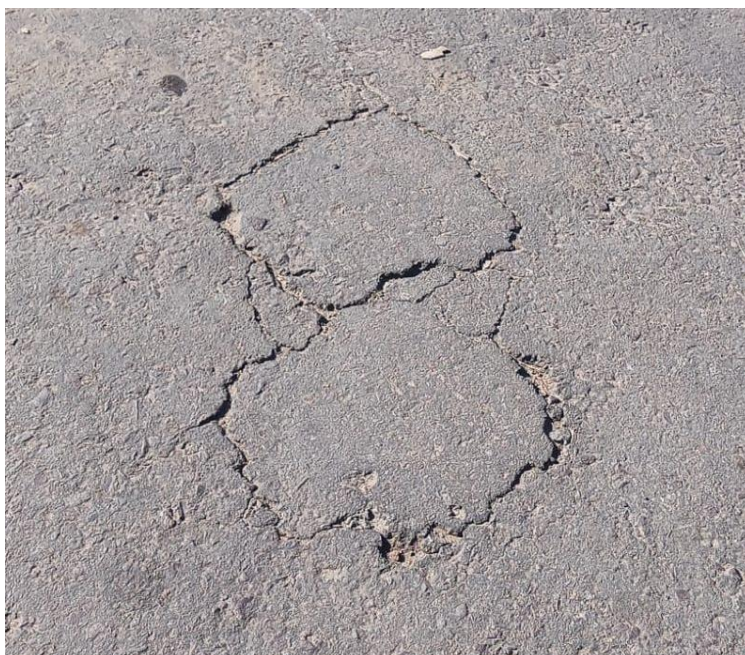
Figura 35 - Trincas de reflexão encontrados na via.
