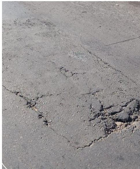
Figura 40 - Panela e Remendo encontrados na via.
