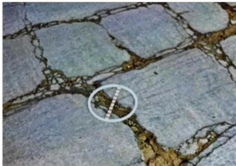
Figura 9 - Superfície de rolamento com trincas tipo bloco.
