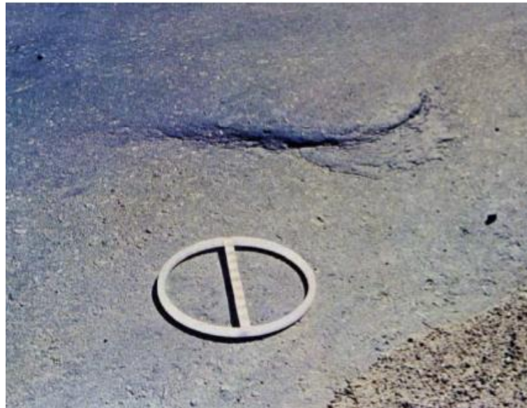
Figura 14 - Superfície de rolamento com escorregamento.
