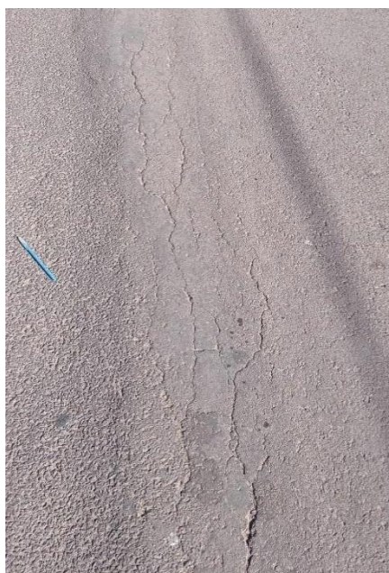
Figura 36 - Trinca isolada longitudinalmente encontrada na via.
