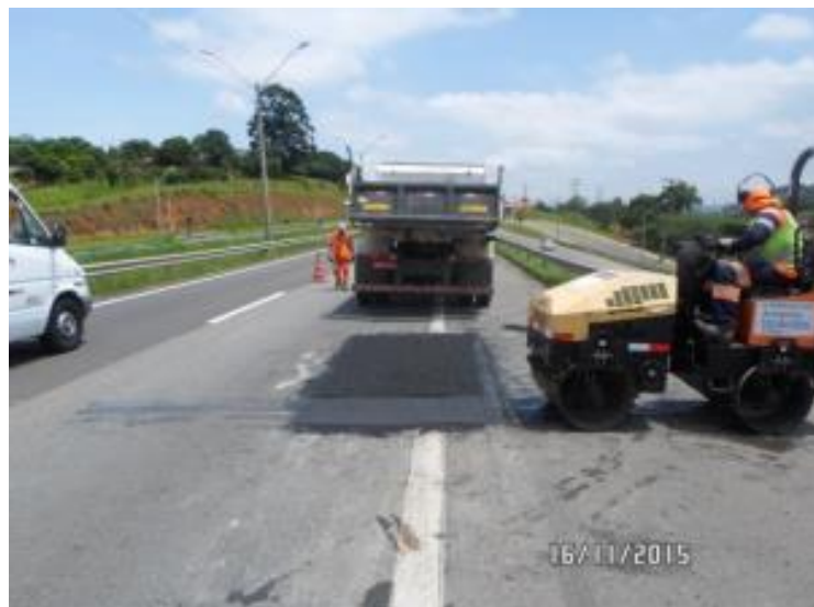
Figura 18 - Superfície de rolamento com remendo.
