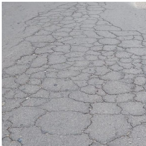
Figura 28 - Trinca interligada do tipo "Couro de Jacaré" encontrado na via.
