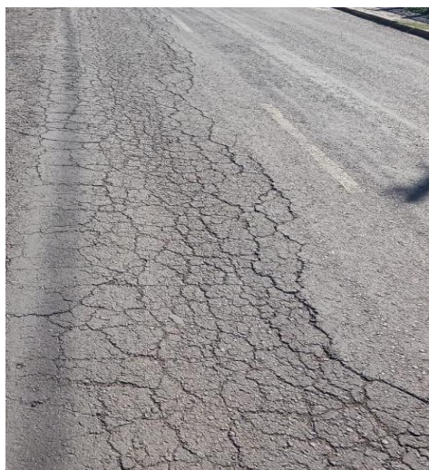
Figura 30 - Trinca interligada do tipo "Couro de Jacaré" encontrado na via.
