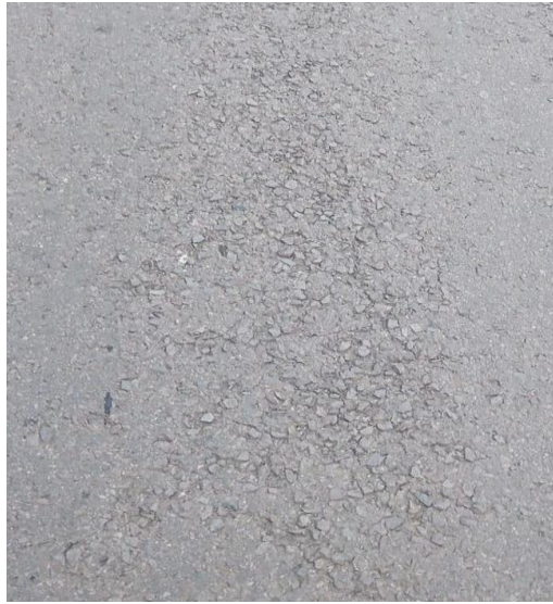
Figura 27 - Desgastes encontrado na via.
