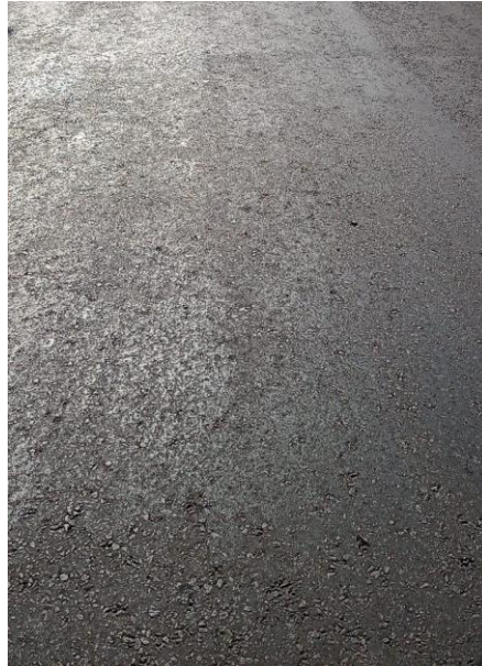
Figura 41 - Desgaste e Exsudação encontrados na via.
