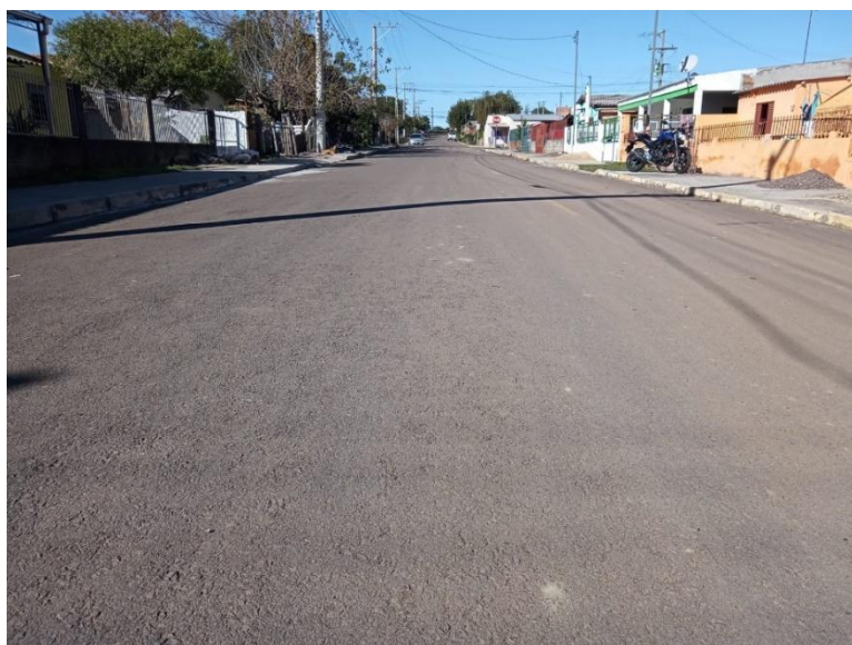
Figura 37 - Estado de conservação da via.
