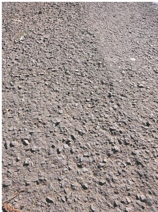
Figura 29 - Desgaste encontrado na via.
