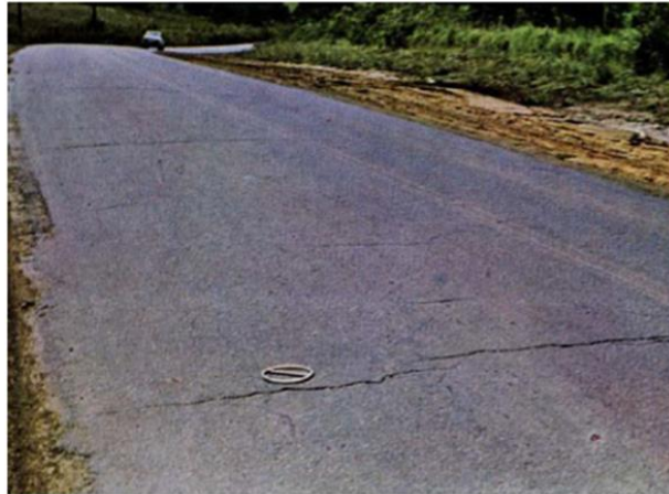
Figura 6 - Superfície de rolamento com trincas transversais.
