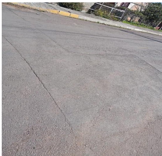
Figura 31 - Remendo encontrado na via.
