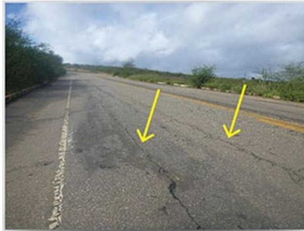
Figura 4 - Superfície de rolamento com fendas.
