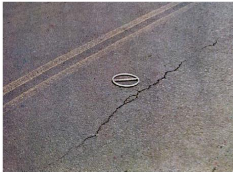
Figura 7 - Superfície de rolamento com trincas longitudinais.
