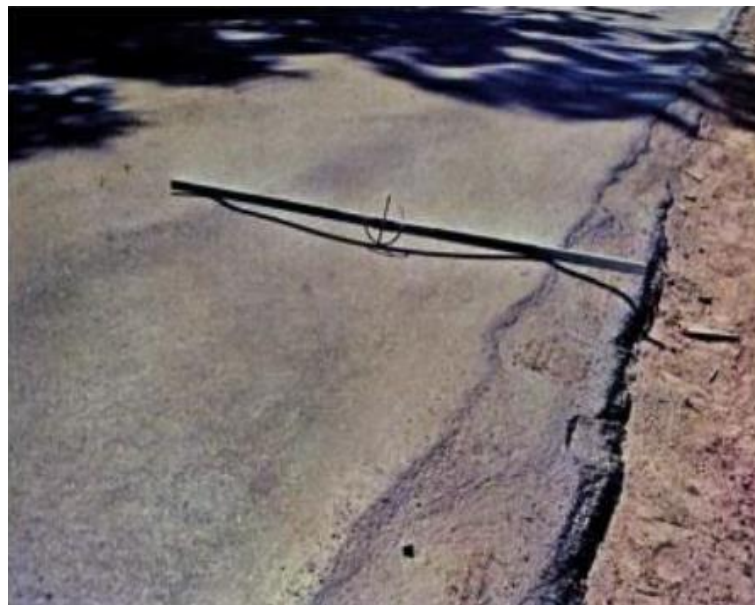
Figura 12 -Superfície de rolamento com afundamento.
