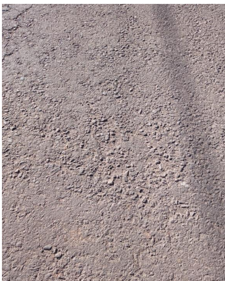
Figura 32 - Desgaste encontrado na via.
