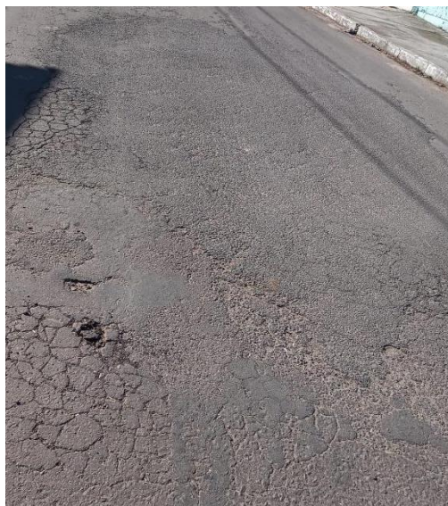
Figura 33 - Panela, Trinca interligada do tipo "Couro de Jacaré" e Remendo encontrados na via.
