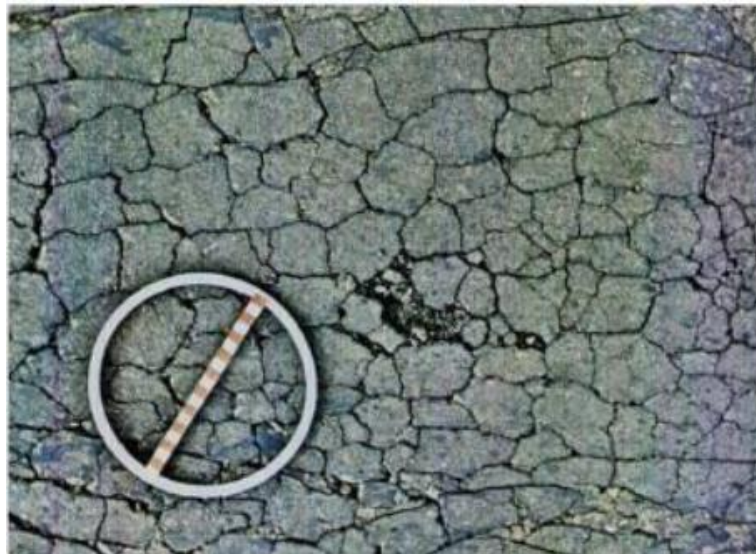
Figura 8 - Superfície de rolamento com trincas tipo "Couro de Jacaré".
