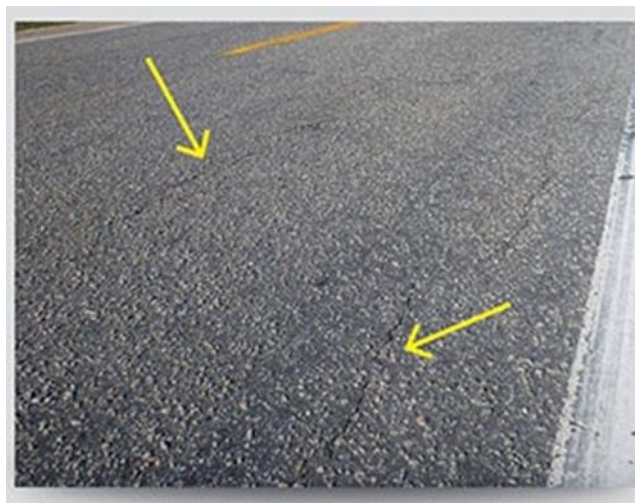
Figura 5 - Superfície de rolamento com fissuras.
