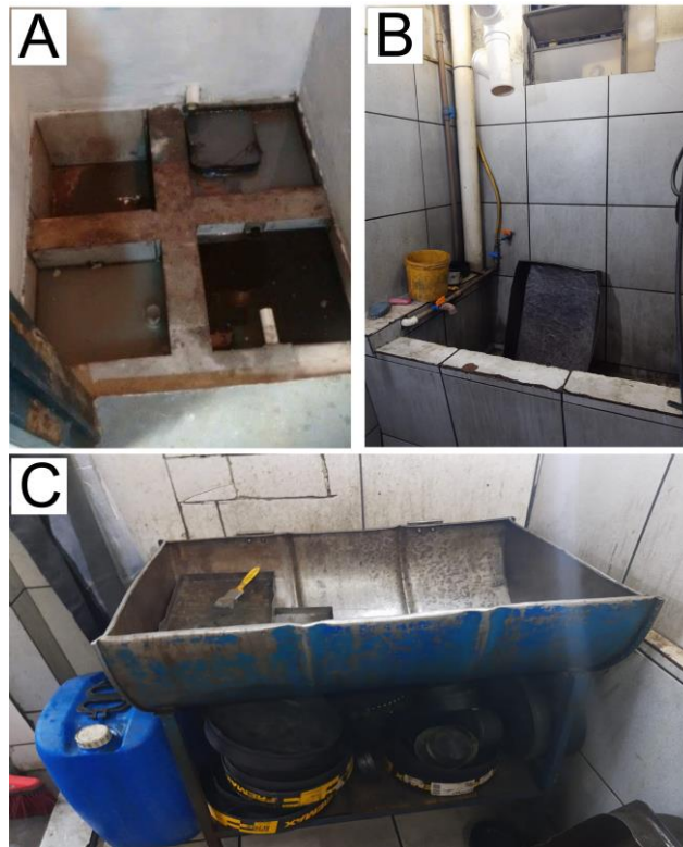
Figura 11 – Figura mostrando a caixa separadora de água e óleo.
