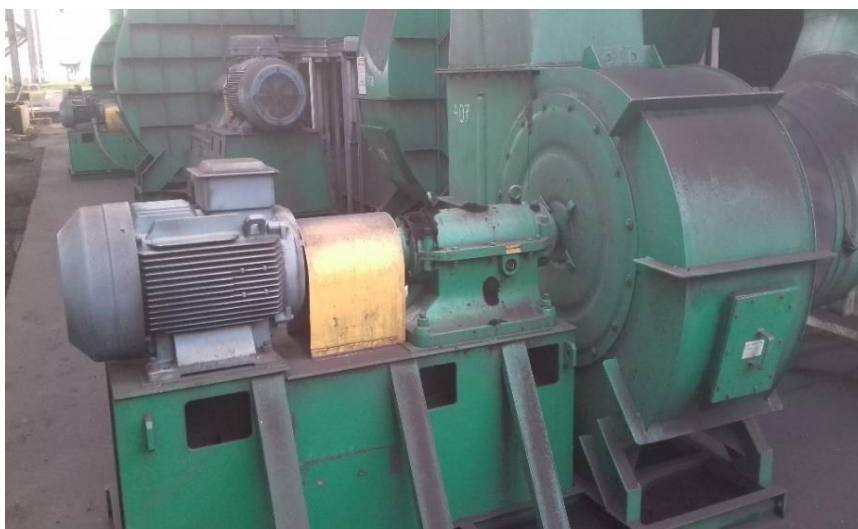
Figura 19 - Ventilador de inserção de ar.
