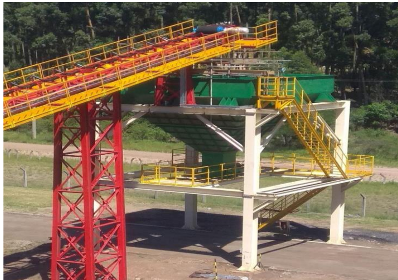
Figura 22- Silo de armazenagem de resíduos.
