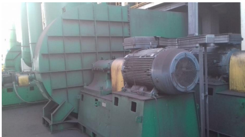
Figura 20 - Ventilador de tiragem induzida.
