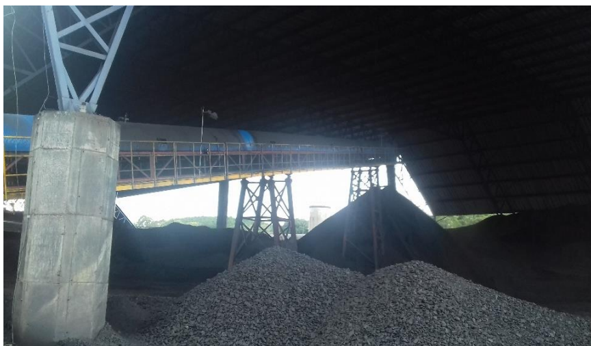
Figura 18- Correia transportadora de carvão beneficiado.
