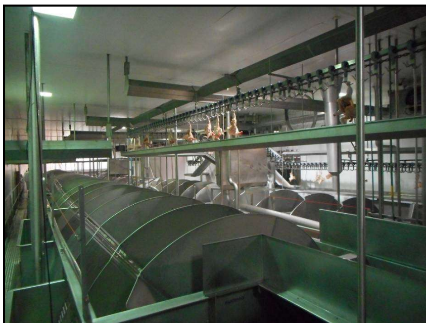
FIGURA 15 - Sala de pré-resfriamento. Na foto os chillers das linhas 2 e 3 respectivamente (Fonte: O Autor).
