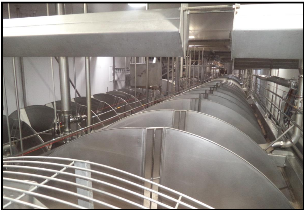
FIGURA 7 - Tanques de chiller presentes na sala de pré-resfriamento.
