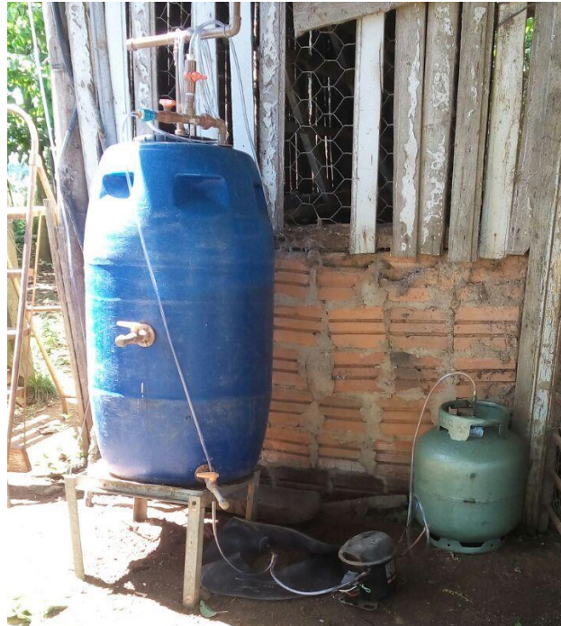
Figura 5- Biodigestor com a câmara conectada a ele e ao botijão de gás
