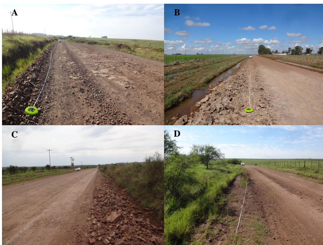
Figura 5 – Levantamento dos defeitos, Método ICRNP. A) U.S. do ramo 1 da estrada do Caverá. B) U.S. do ramo 1 do Silvestre. C) U.S. do ramo 1 da estrada do Rincão de São Miguel. D) U.S. do ramo 1 do Angico. Fonte: Própria.
