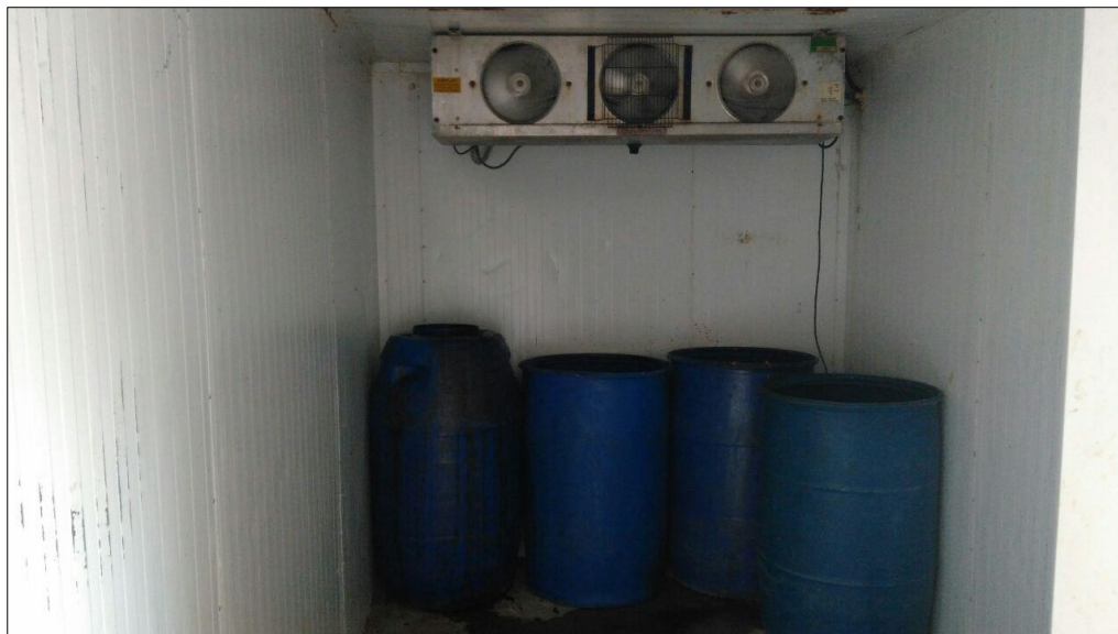
Figura 11 - Câmara Fria e tonéis de armazenamento
