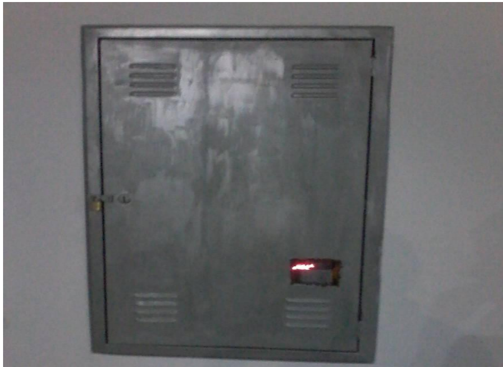
FIGURA 14 - Banco capacitor, encontrado no Hotel A. Fonte: Autor, 2014.
