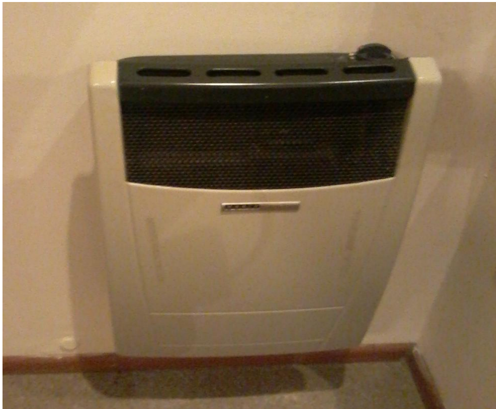
FIGURA 11 - Sistema de calefação a gás.
