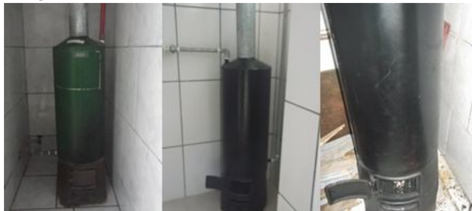
Figuras 12A, 12B e 12C - Caldeiras de aquecimento de água dos chuveiros, no 9º RCB, no município de São Gabriel, RS.
