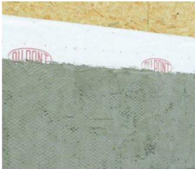
Figura 18 – Revestimento de argamassa aplicado sobre placas de OSB com manta de polietileno e tela de aço expandida
