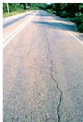
(b) Trincas longitudinais longas (TLL)
