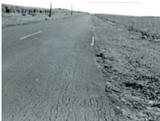
(e) Conjunto de trincas longitudinais longas
