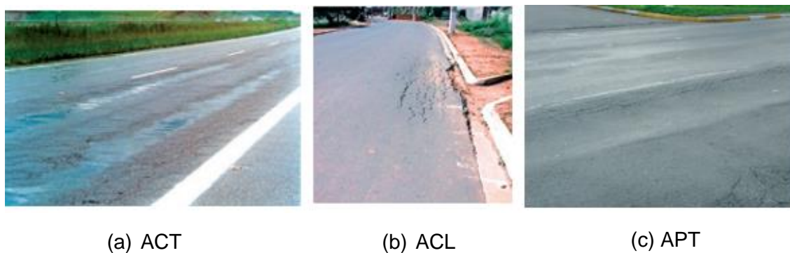
Figura 2 – Tipos comuns de afundamentos
