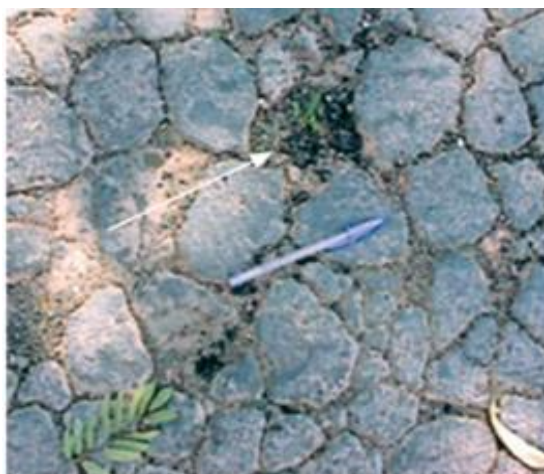
(c) Trincas tipo couro de jacaré com erosão (JE)
