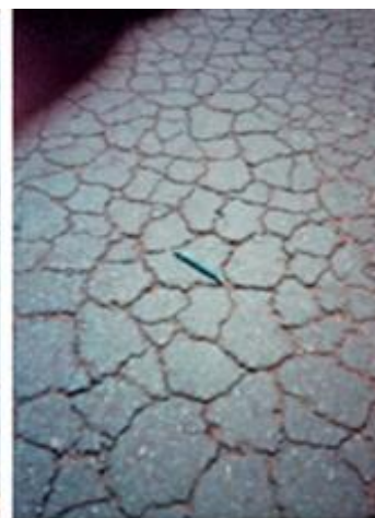
(d) Trincas tipo couro de jacaré de jacaré (J)
