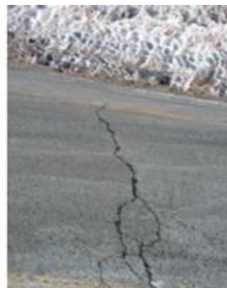
(f) Trincas de retração térmica
