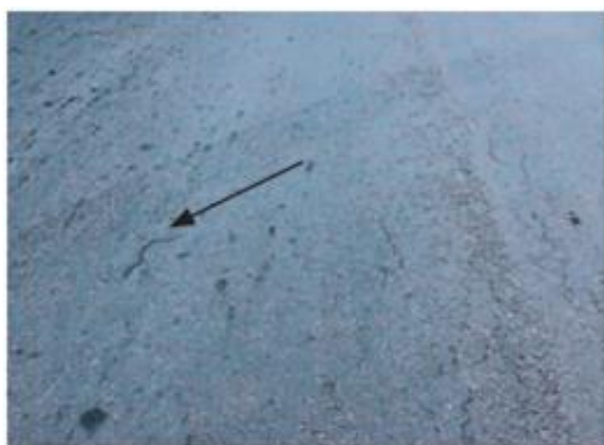
(a) Trincas longitudinais curtas (TLC)
