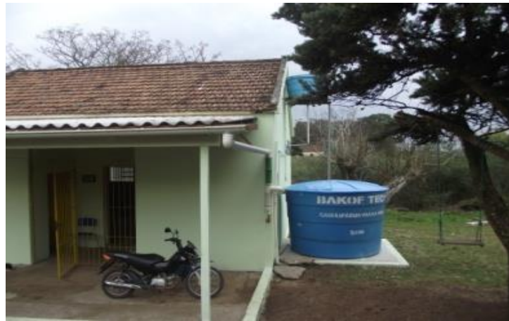
Figura 3 - Sistema de captação de água da chuva do telhado.
