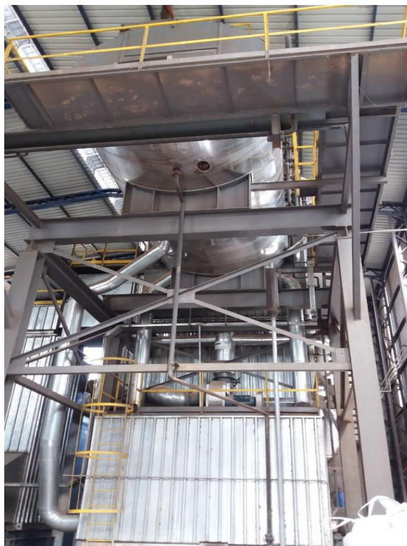
Figura 15 - Caldeira à grelha
