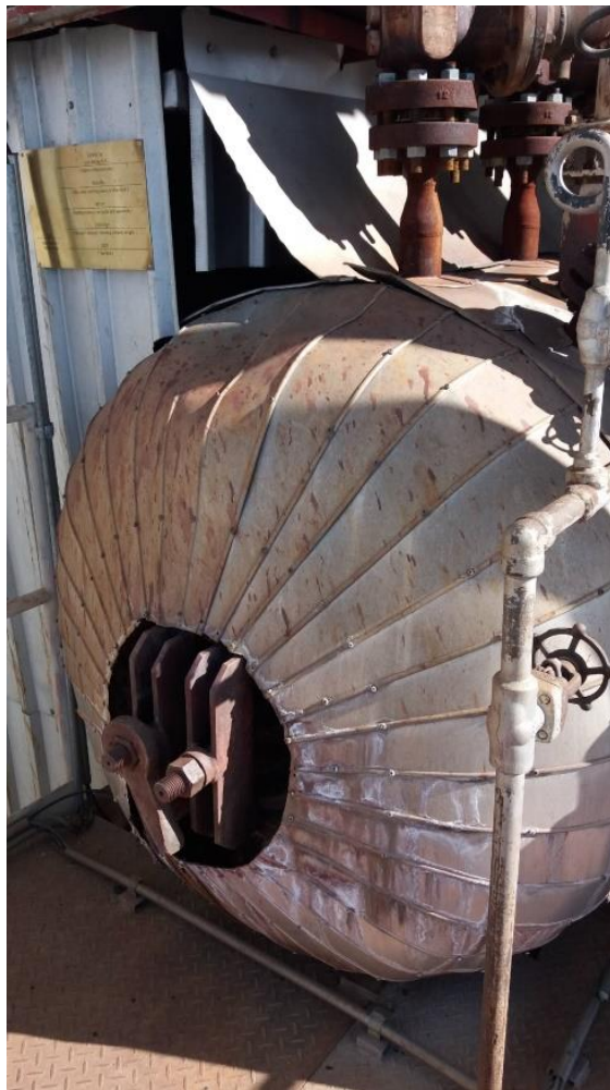
Figura 38 - Balão da caldeira
