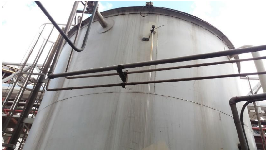
Figura 33 - Um dos tanques de entrada de água
