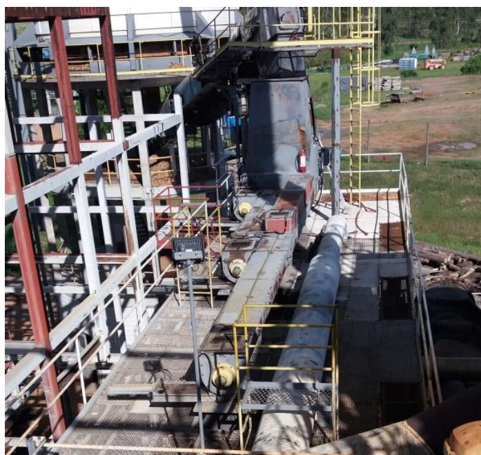
Figura 28 - Tremonha e parafusos de alimentação dos gaseificadores
