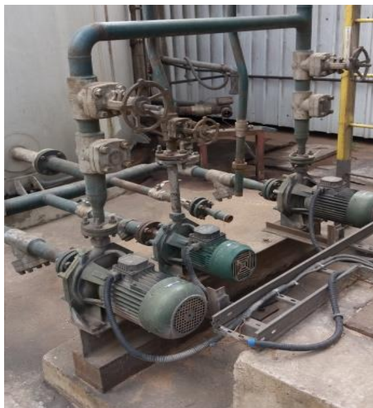
Figura 34 – Bombas saída tanques
