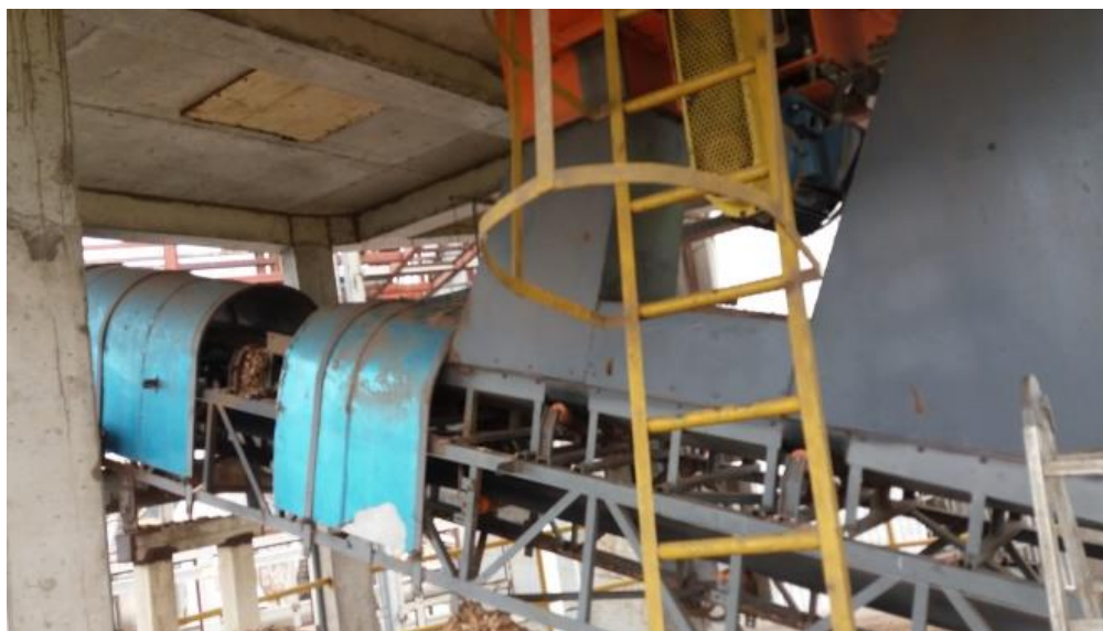
Figura 27 - Esteira de saída do silo de cavaco
