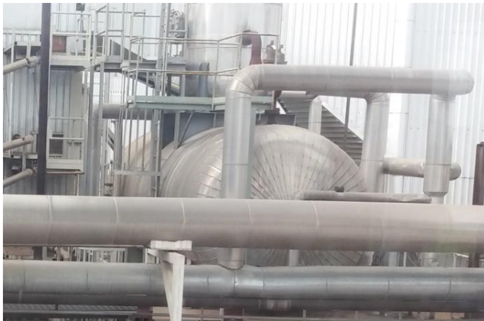
Figura 35 - Tanque de alimentação
