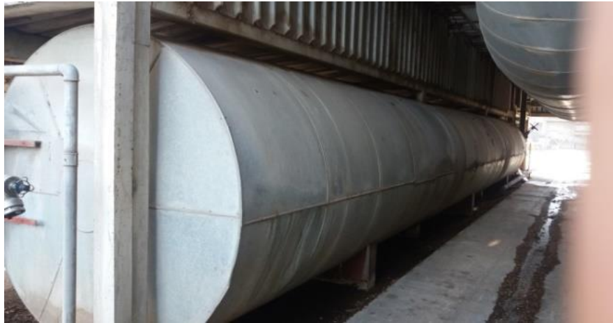
Figura 43 - Tanque de condensado
