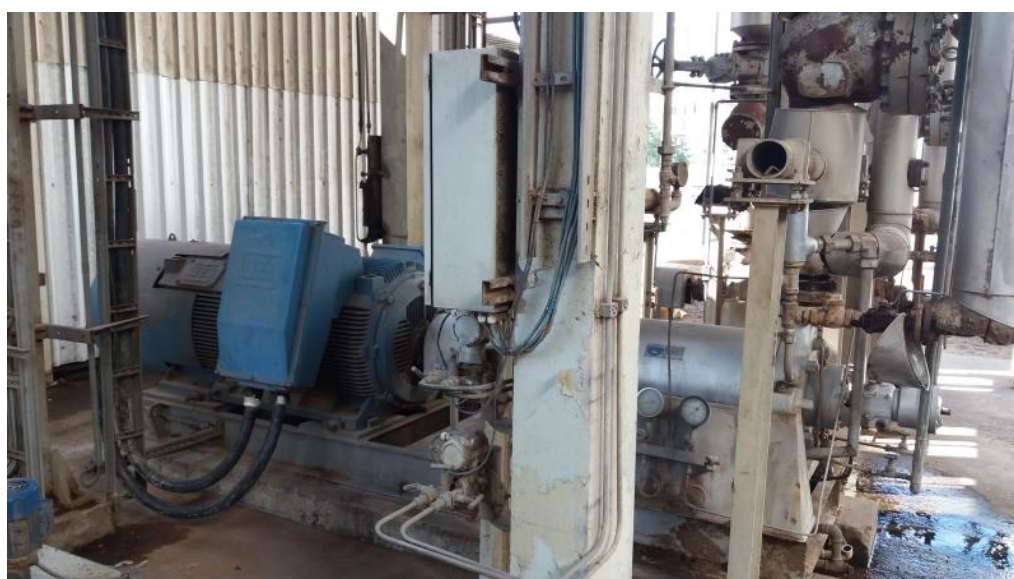
Figura 36 - Bombas de 65 bar
