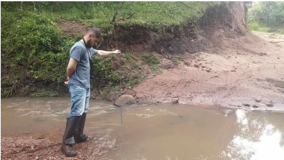
Figura 28 - Drenagem assoreada para passagem de animais localizada no ponto SM-VZ-09.
