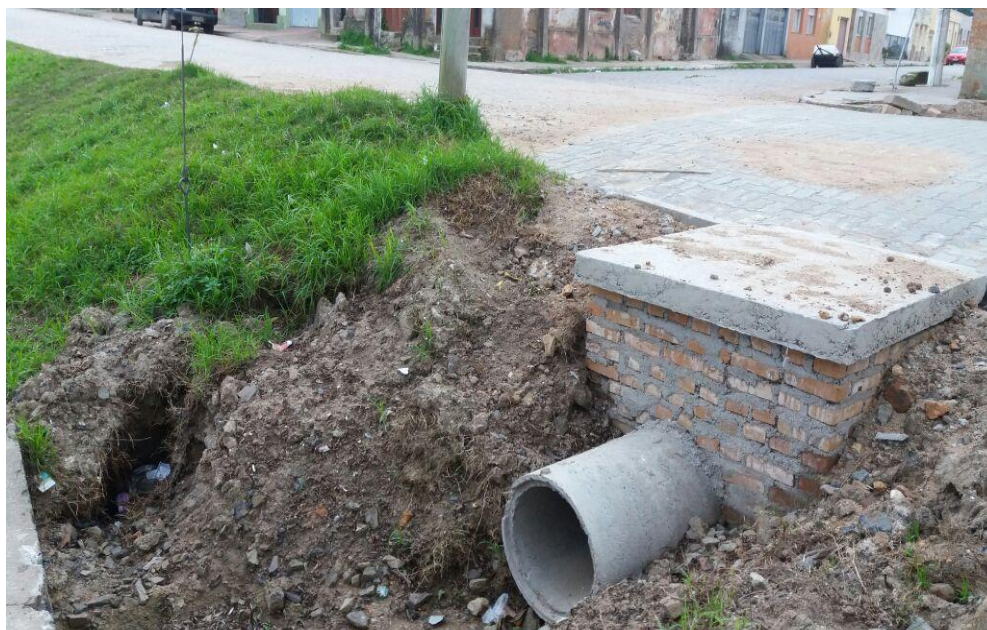
Figura 24 – Esgoto a céu aberto escorrendo rio adentro
