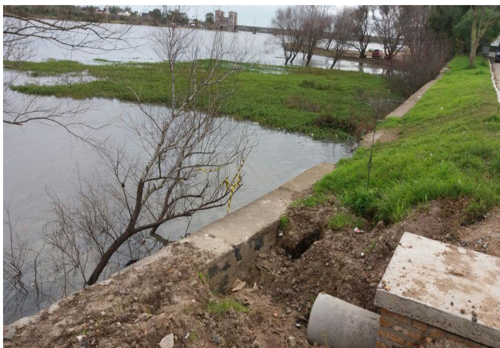
Figura 25 – Esgoto desembocando direto no rio
