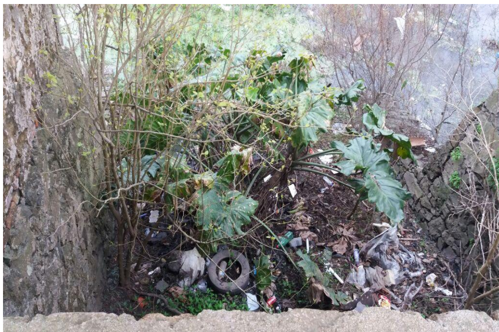
Figura 26 – Lixo nas saídas de esgoto
