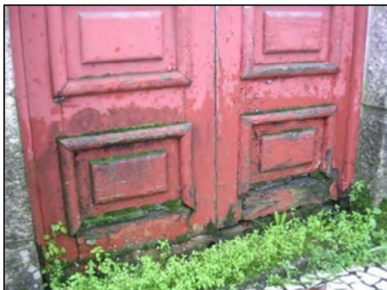
Figura 39 - Esquadria de Madeira em estado avançado de degradação
