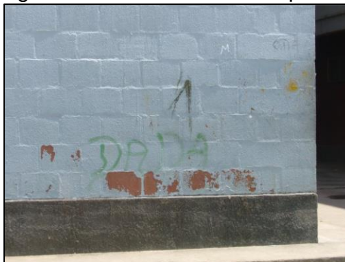
Figura 17 - Destacamento da pintura
