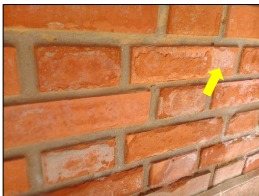
Figura 8 - Eflorescência na Alvenaria
