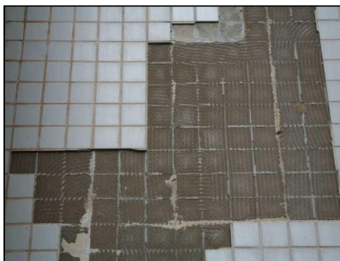
Figura 37 - Deslocamento de Revestimento Cerâmicos
