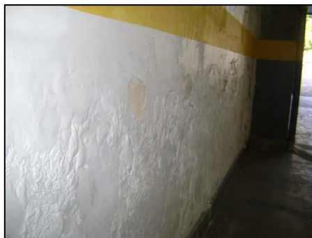
Figura 12 – Empolamento em uma parede.
