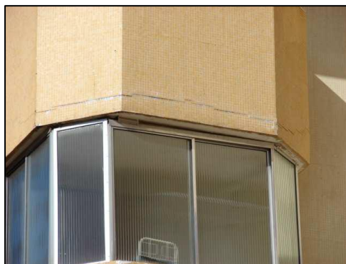
Figura 23 - Fissura acompanhando sentido da viga
