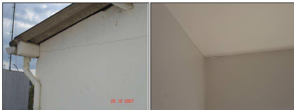
Figura 27 - Fissuras resultantes de movimentação térmica da laje.
