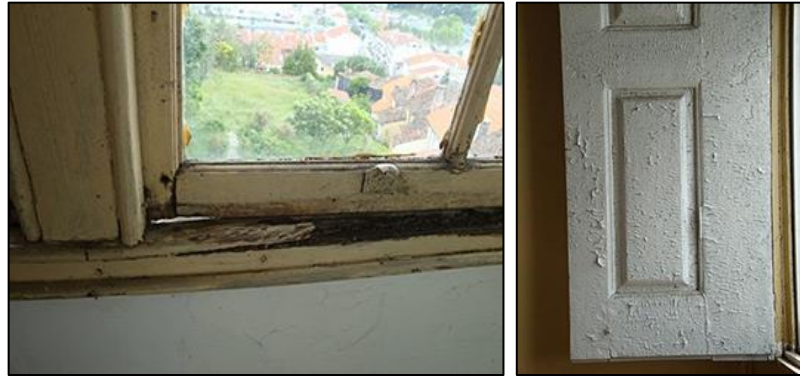
Figura 42 - Patologias em esquadrias de Madeira
