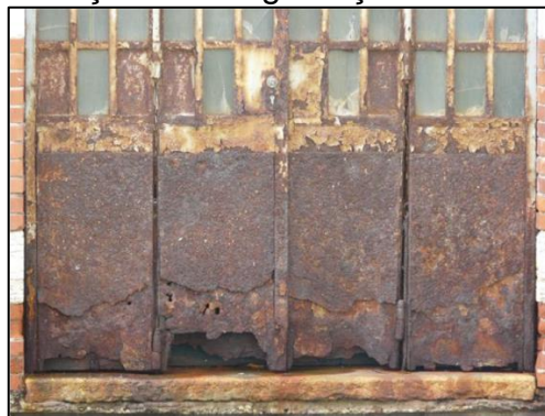
Figura 43 - Estado avançado de degradação de uma esquadria metálica.
