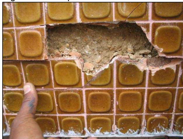
Figura 34- Rompimento de revestimento cerâmico.
