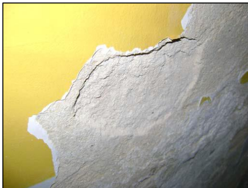
Figura 13 - Descolamento em Placa
