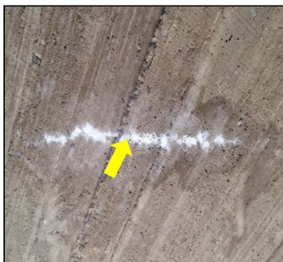
Figura 7 - Eflorescência no concreto
