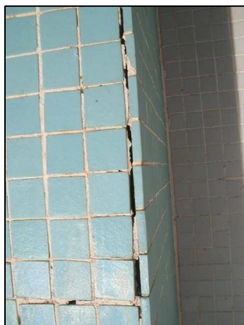
Figura 38 - Falha no Rejunte
