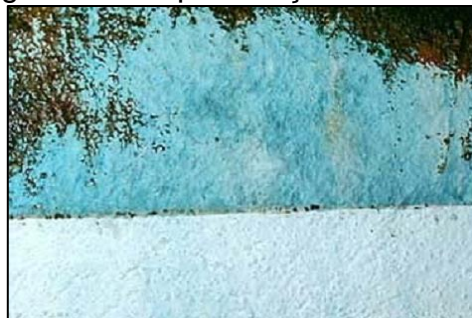
Figura 11 - Saponificação em Reboco
