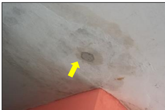
Figura 9- Mancha no teto
