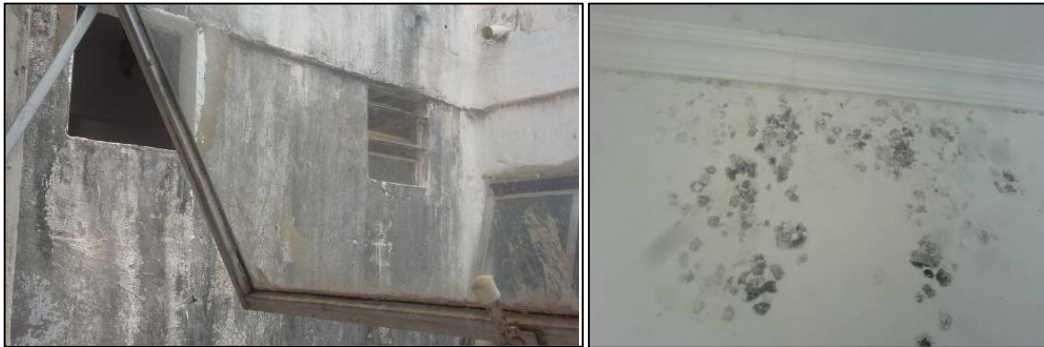
Figura 10 - Bolor em parede
