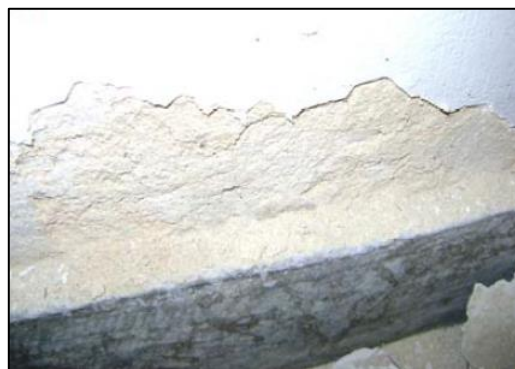
Figura 15 - Descolamento com pulverulência
