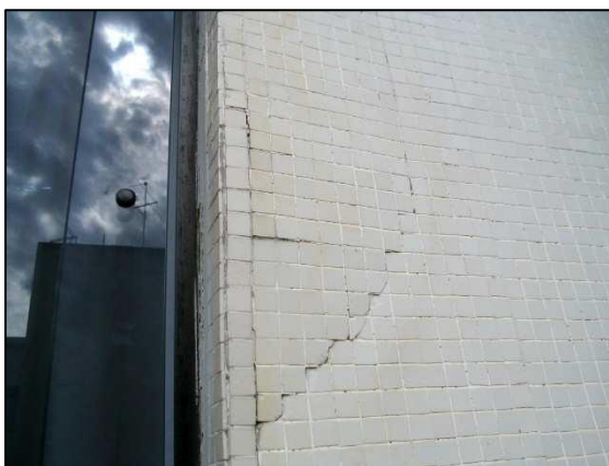
Figura 35 - Descolamento de Revestimento Cerâmicos
