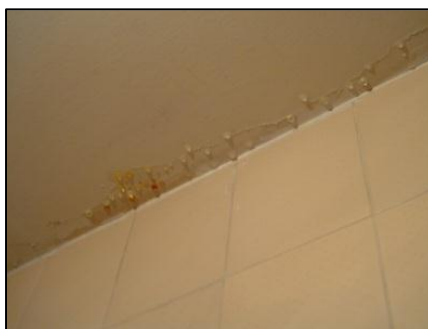
Figura 6 - Infiltração na Laje.
