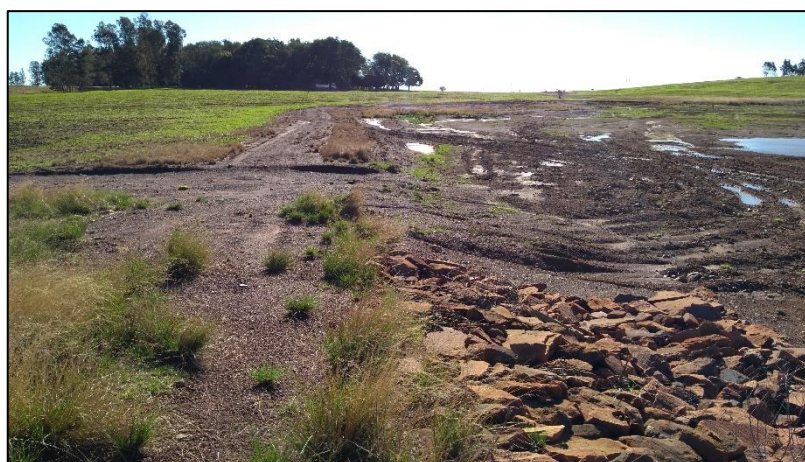
Figura 104 – Aterro no vertedouro da propriedade B-08
