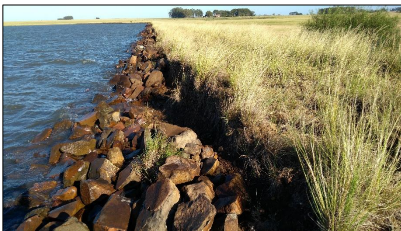
Figura 48 – Ameaça de transbordamento da propriedade B-02
