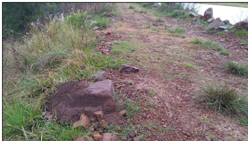
Figura 45 – Formigueiro no coroamento da propriedade B-05
