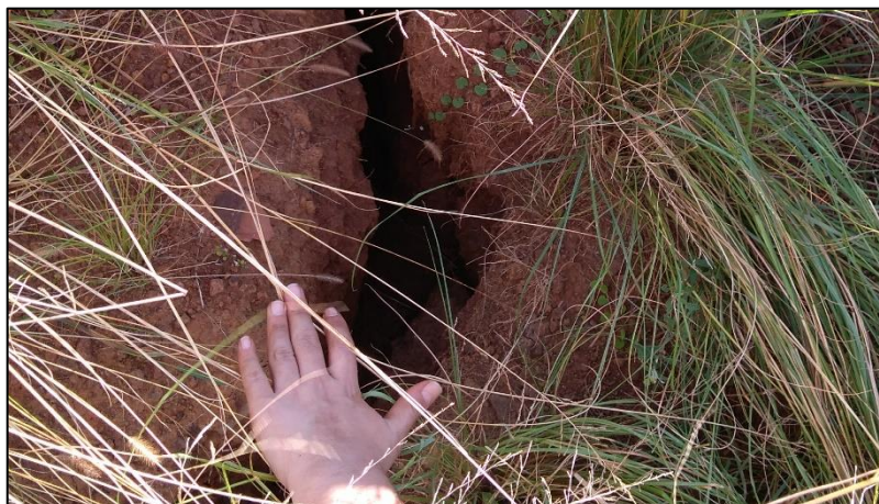
Figura 76 – Sinais de movimento no talude a jusante da propriedade B-08
