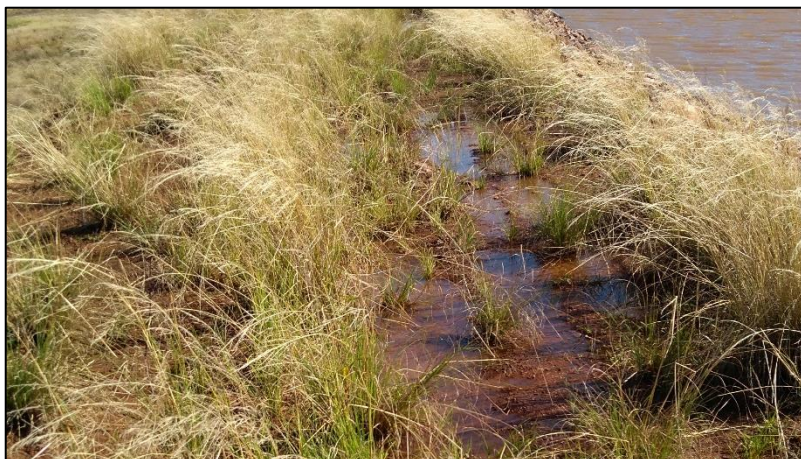
Figura 41 – Defeitos na drenagem do coroamento da propriedade B-08
