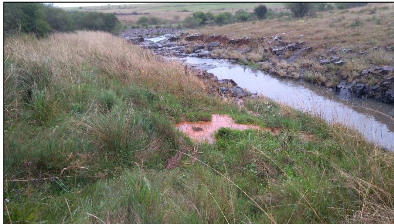
Figura 85 – Fuga d'água na região a jusante da propriedade B-05
