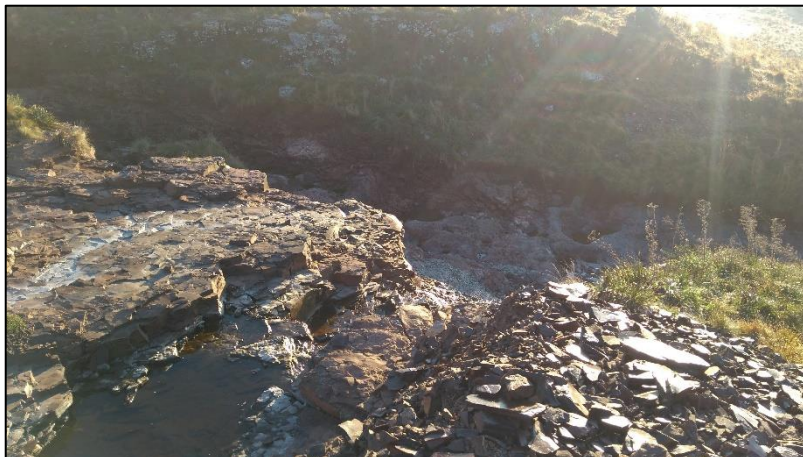
Figura 93 – Erosões ou escorregamentos do vertedouro da propriedade B-07
