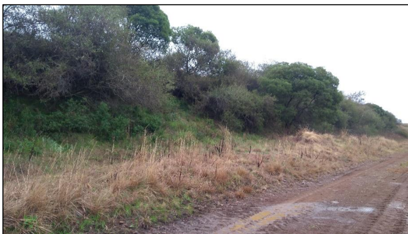
Figura 70 – Árvores e arbustos no talude a jusante da propriedade B-05
