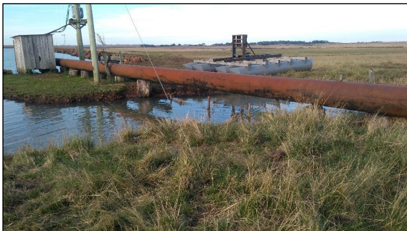
Figura 100 – Construção irregular no vertedouro da propriedade B-04
