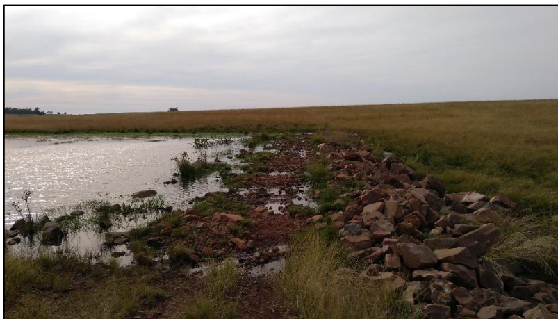
Figura 99 – Aterro no vertedouro da propriedade B-03
