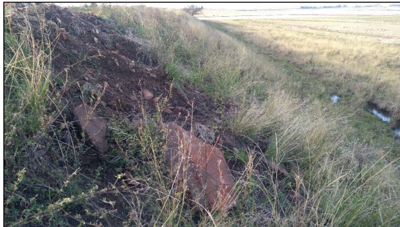
Figura 62 – Falha proteção vegetal no talude a jusante da propriedade B-04
