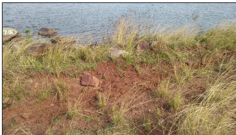
Figura 38 – Afundamentos e buracos no coroamento da propriedade B-06
