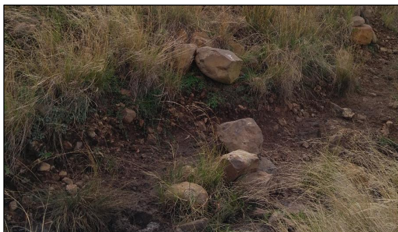
Figura 66 – Falha proteção vegetal no talude a jusante da propriedade B-03
