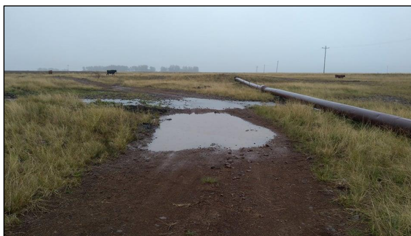
Figura 40 – Defeitos na drenagem do coroamento da propriedade B-01
