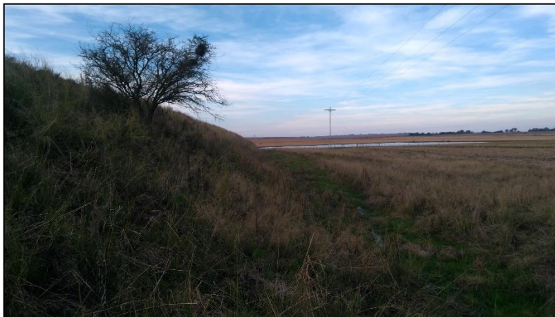
Figura 69 – Árvores e arbustos no talude a jusante da propriedade B-04
