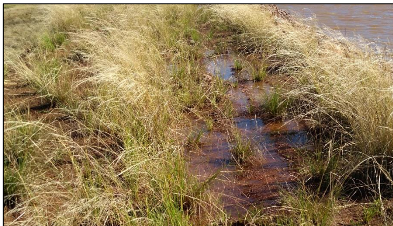
Figura 39 – Afundamentos e buracos no coroamento da propriedade B-08
