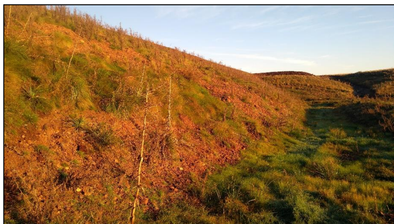
Figura 64 – Falha proteção vegetal no talude a jusante da propriedade B-07
