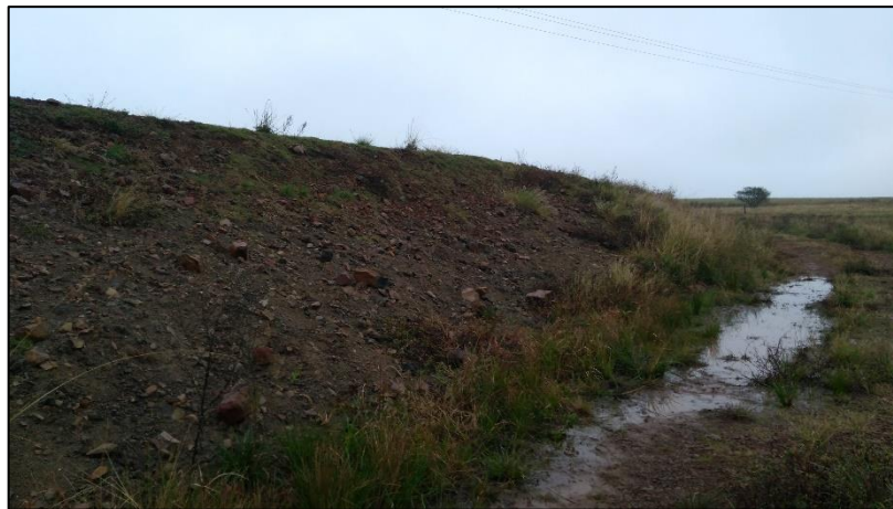
Figura 63 – Falha proteção vegetal no talude a jusante da propriedade B-05
