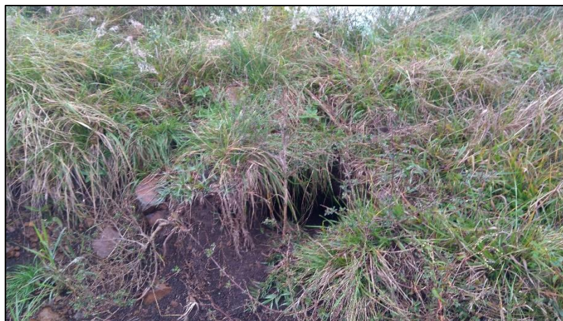
Figura 73 – Toca de animal no talude a jusante da propriedade B-05
