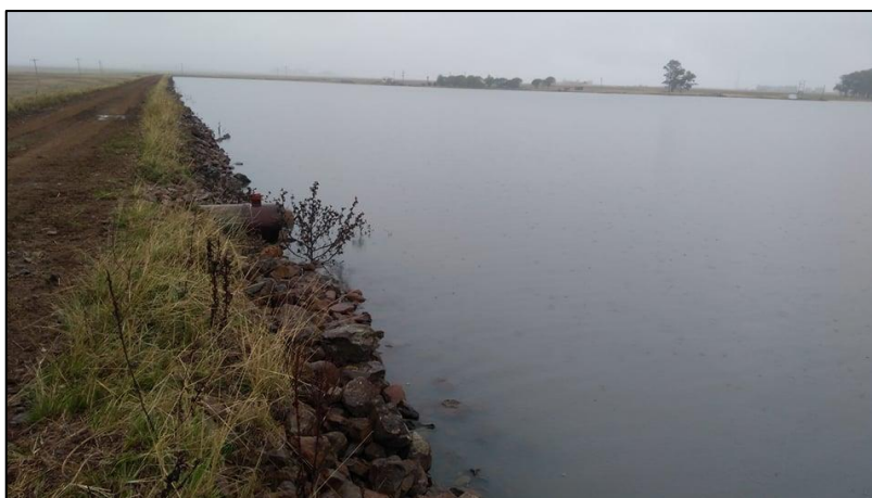
Figura 47 – Ameaça de transbordamento da propriedade B-01
