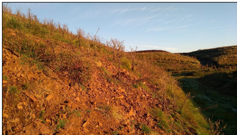
Figura 55 – Erosão no talude a jusante da propriedade B-07
