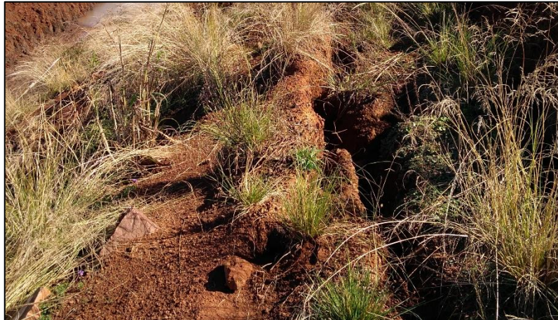
Figura 67 – Afundamento ou buracos no talude a jusante da propriedade B-08
