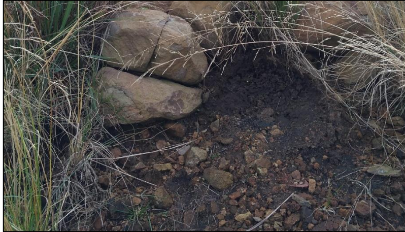
Figura 71 – Formigueiro no talude a jusante da propriedade B-03
