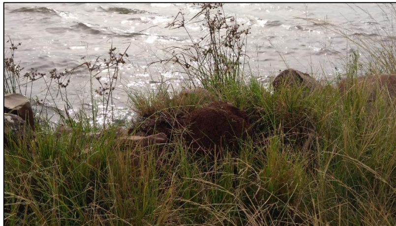
Figura 43 – Formigueiro no coroamento da propriedade B-03
