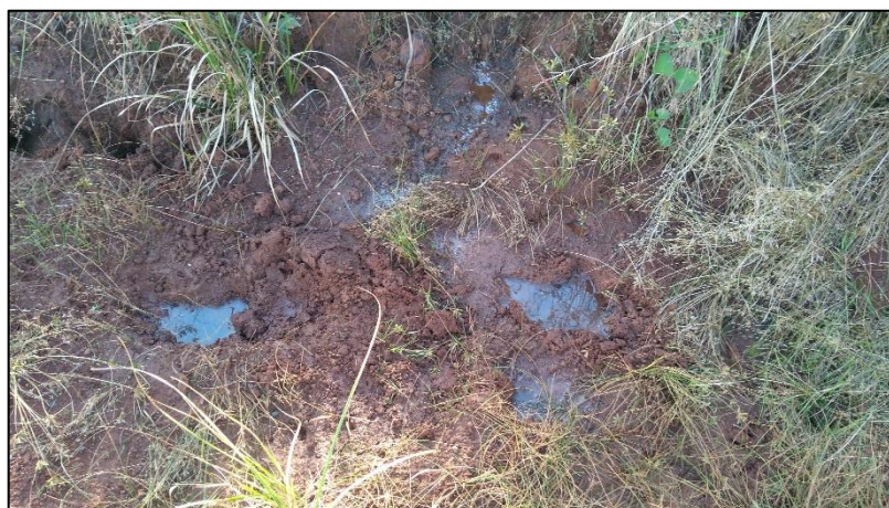
Figura 80 – Fuga d'água e áreas úmidas no talude a jusante da propriedade B-08
