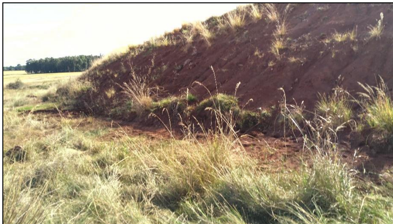
Figura 65 – Falha proteção vegetal no talude a jusante da propriedade B-08
