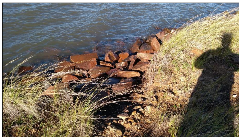
Figura 37 – Afundamentos e buracos no coroamento da propriedade B-02
