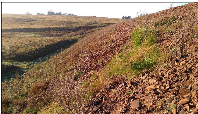
Figura 75 – Sinais de movimento no talude a jusante da propriedade B-07
