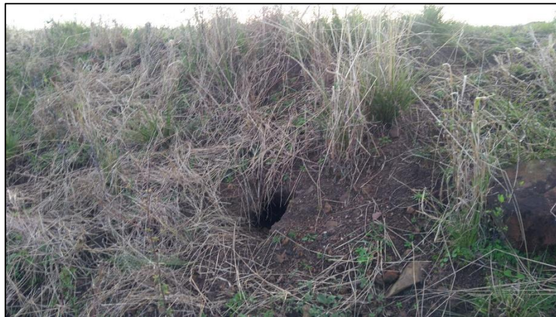
Figura 72 – Toca de animal no talude a jusante da propriedade B-04
