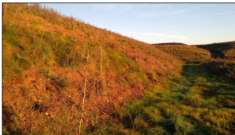
Figura 87 – Fuga d'água na região a jusante da propriedade B-07
