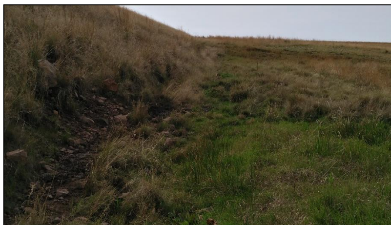
Figura 61 – Falha proteção vegetal no talude a jusante da propriedade B-03
