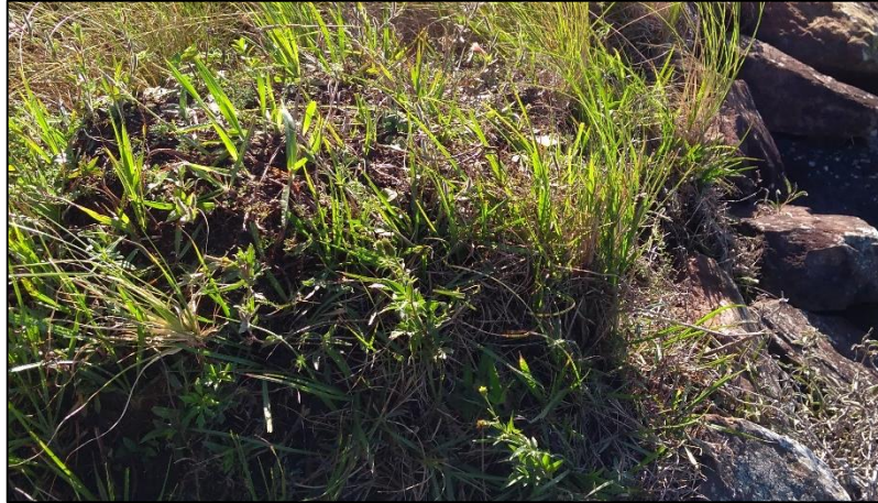
Figura 42 – Formigueiro no coroamento da propriedade B-02
