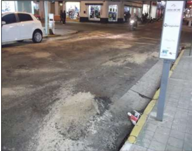
Figura 21 – Aspecto da Rua dos Andradas no período da noite pós-manutenção
