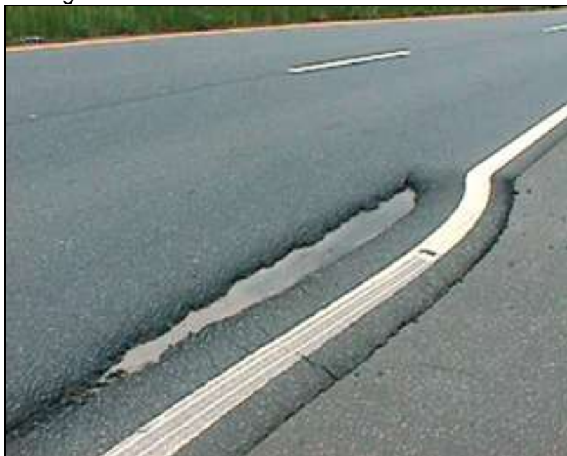
Figura 10 – Escorregamento de revestimento betuminoso
