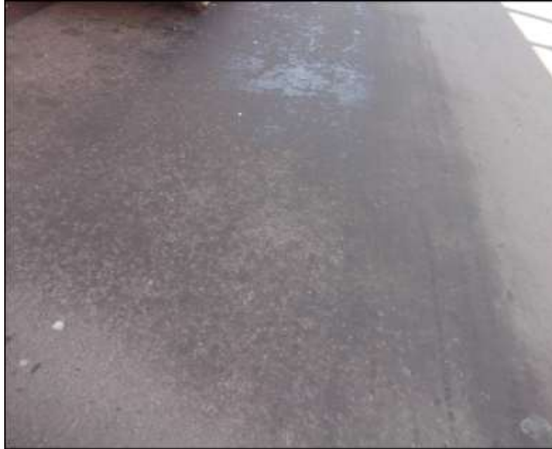
Figura 6 – Exsudação de asfalto vista na Rua Barão do Amazonas – Alegrete-RS
