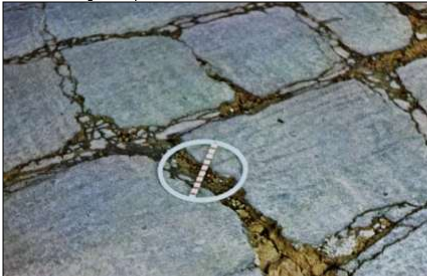
Figura 14 – Trinca interligada tipo bloco
