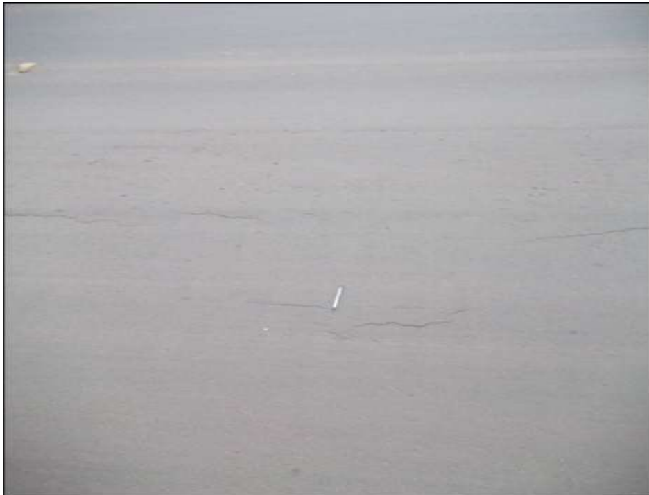
Figura 12 – Trinca isolada transversal
