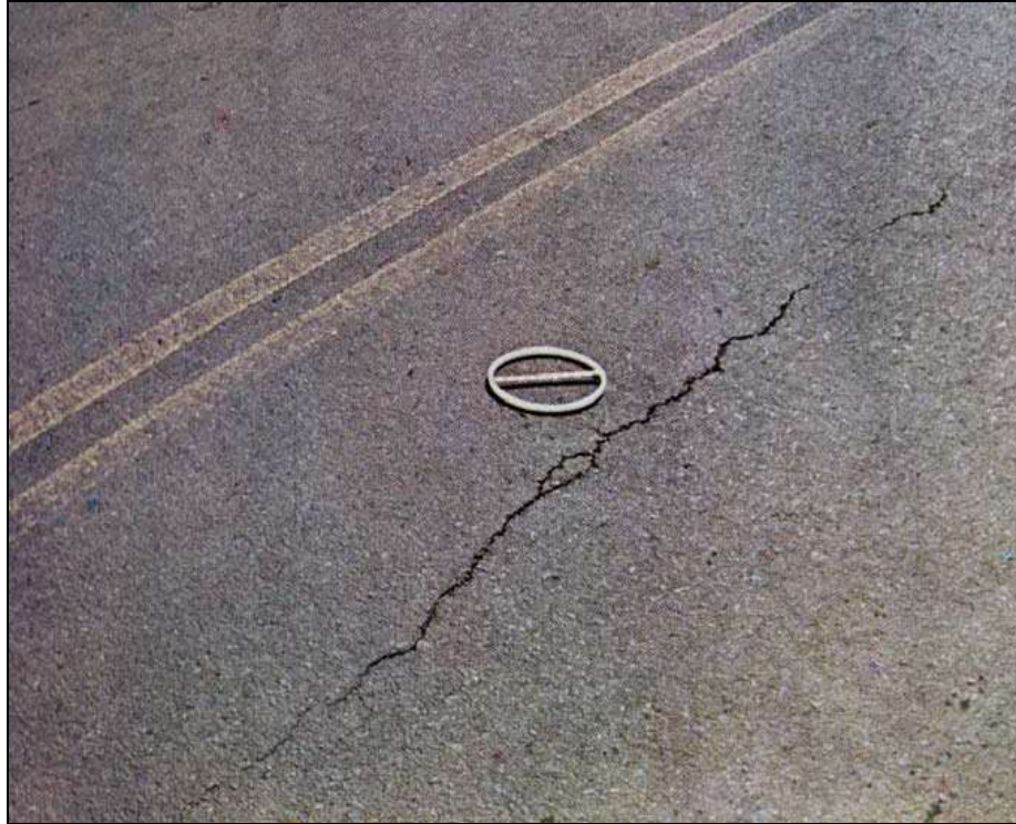
Figura 13 – Trinca isolada longitudinal
