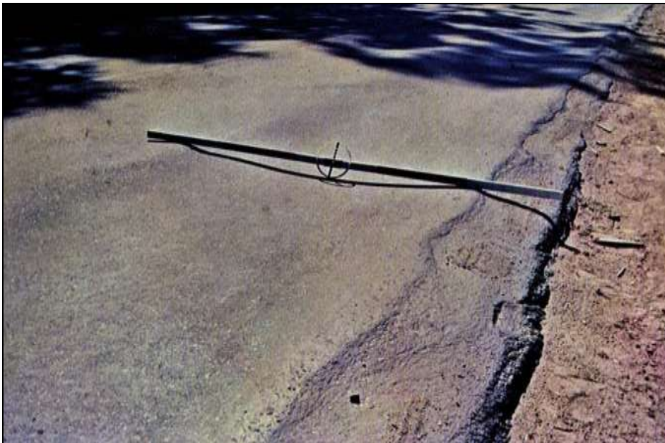
Figura 4 – Afundamento de trilha de roda
