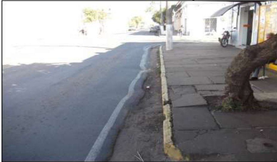
Figura 3 – Afundamento local na Av. Assis Brasil – Alegrete-RS
