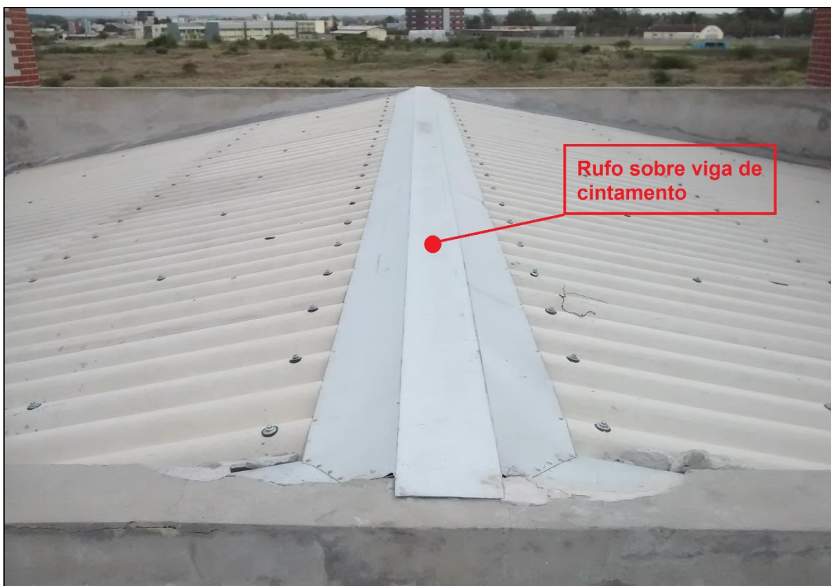
Figura 28 – Solução in loco adotada para conflito mostrado na figura 27
