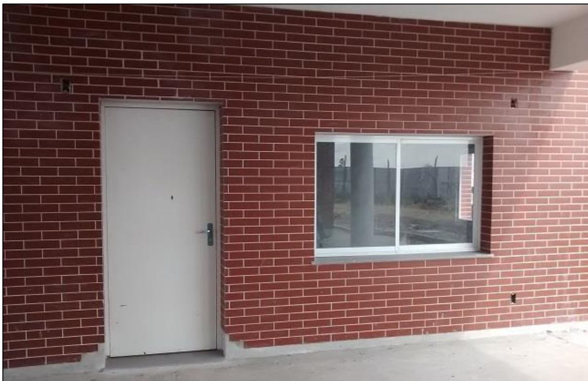
Figura 25 – Solução in loco adotada para o conflito mostrado na figura 24
