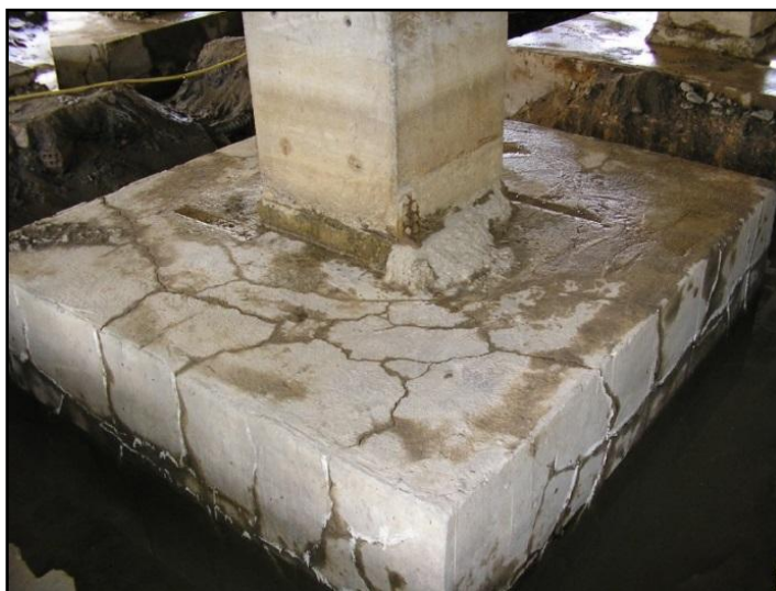
Figura 1 - Degradação da estrutura causada pela RAA
