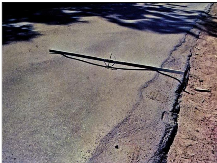
Figura 10 – Afundamento de trilha de roda
