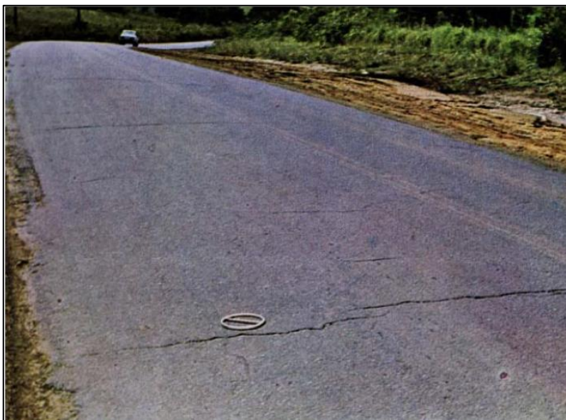
Figura 7 – Trinca isolada transversal
