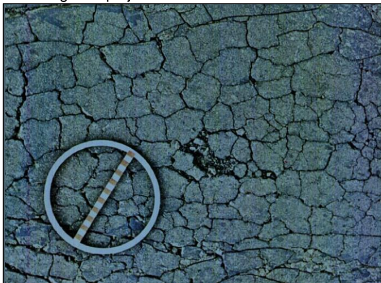
Figura 8 – Trinca interligada tipo jacaré
