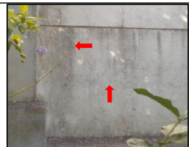
Bolor (parede contínua); Fissuras Mapeadas.
