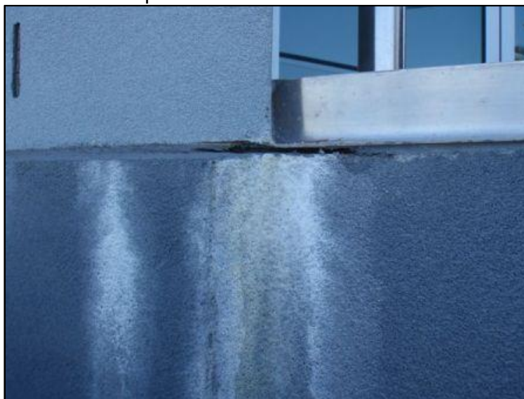
Figura 14 - Eflorescência em paredes
