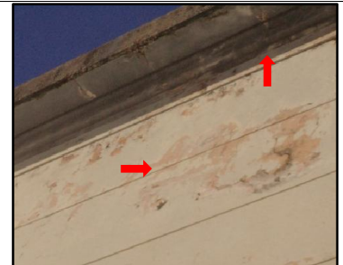
Desagregação da pintura; Bolor.
