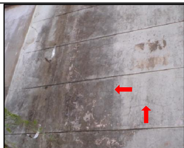
Bolor (parede contínua); Fissuras Mapeadas.
