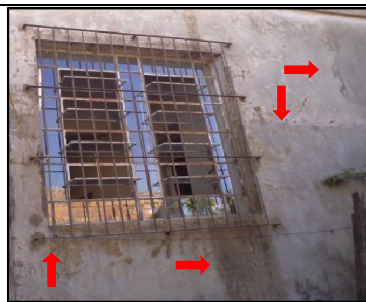
Manchas; Fissuras Inclinadas; Bolor.
