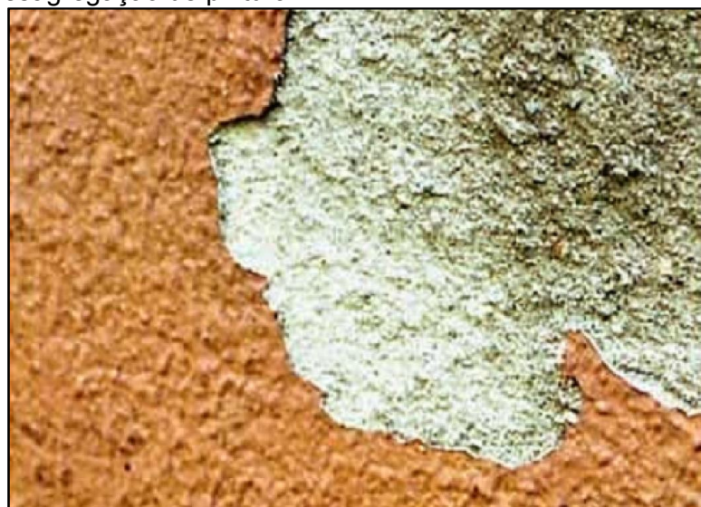
Figura 16 - Desagregação de pintura
