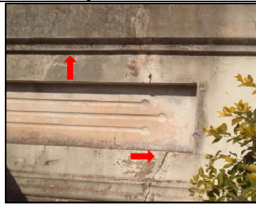
Bolor (parte isolada); Fissura vertical.
