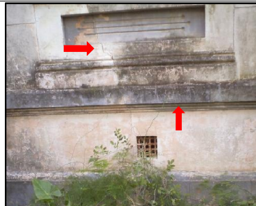
Fissura Inclinada; Bolor.
