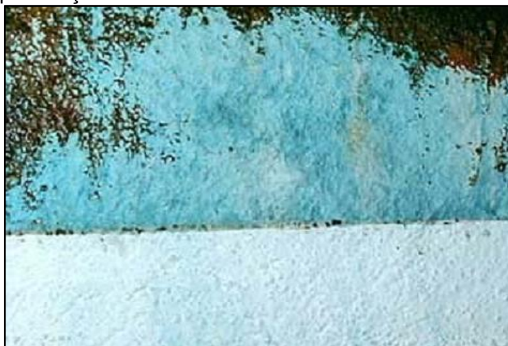
Figura 18 - Saponificação em reboco
