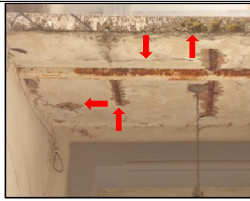
Bolor (parte isolada); Fissura horizontal; corrosão de armaduras, descolamento de argamassa.
