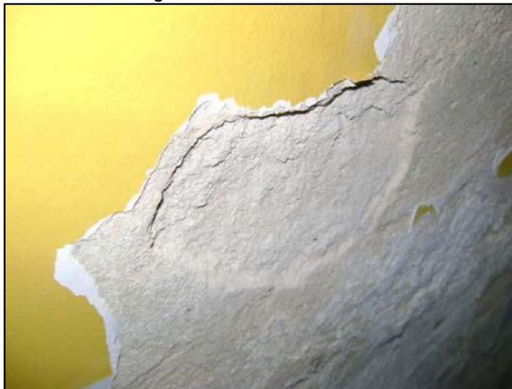
Figura 2 - Descolamento da Argamassa
