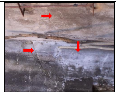
Fissura Inclinada; Bolor; Eflorescência.
