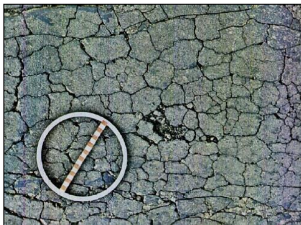
Figura 6 – Trinca interligada do tipo couro de jacaré
