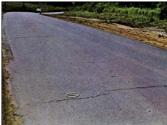
Figura 4 – Trinca isolada transversal
