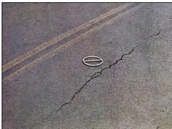
Figura 5 – Trinca isolada longitudinal
