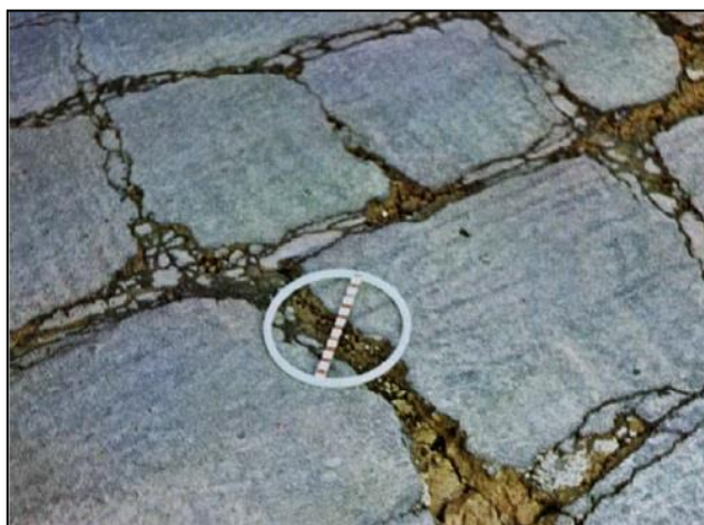
Figura 7 – Trinca interligada do tipo bloco
