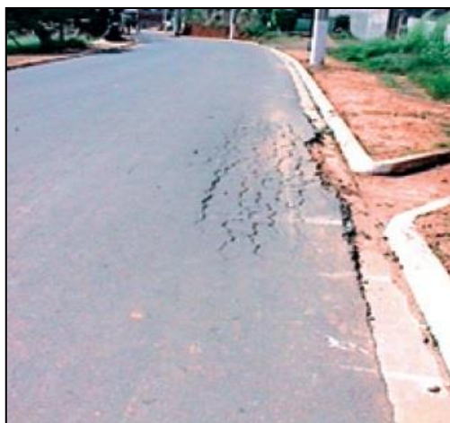
Figura 9 – Afundamento por consolidação localizado
