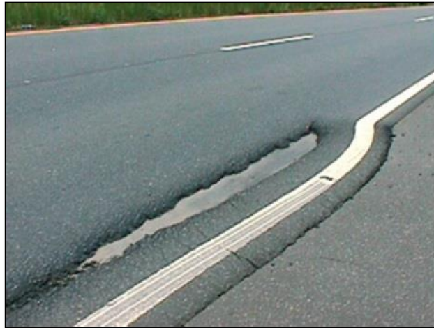
Figura 11 - Escorregamento do revestimento asfáltico
