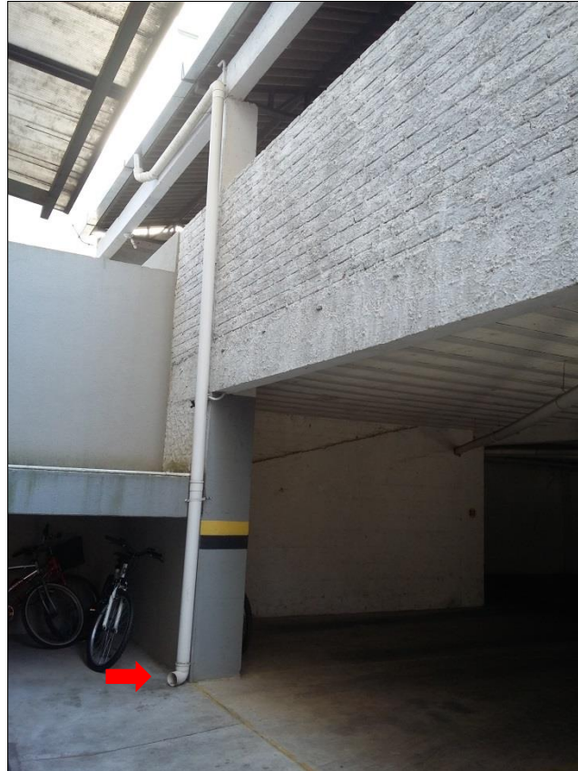
Figura 14 – Condutor de drenagem pluvial (Condutor 6)
