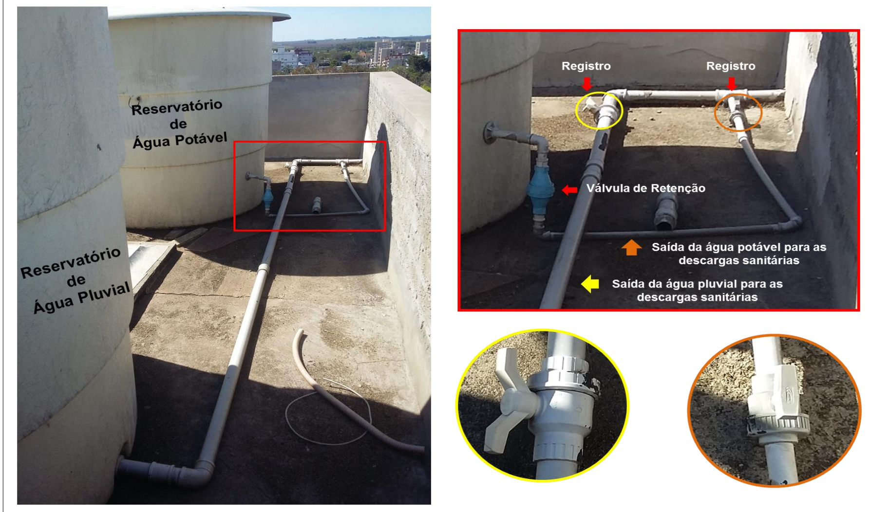
Figura 26 – Reservatórios de abastecimento das descargas sanitárias (tubulações de saída da água dos reservatórios)
