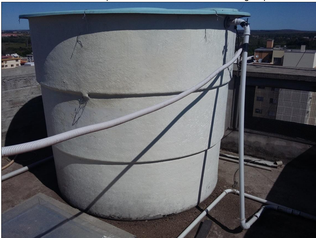
Figura 17 – Reservatório superior de armazenamento de água pluvial
