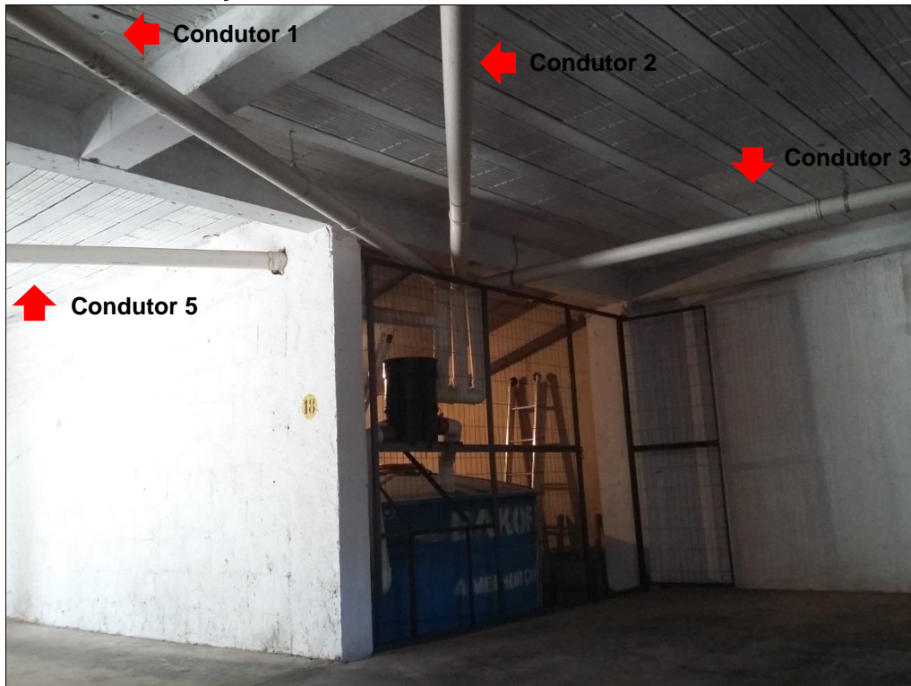
Figura 15 – Alimentação do reservatório inferior
