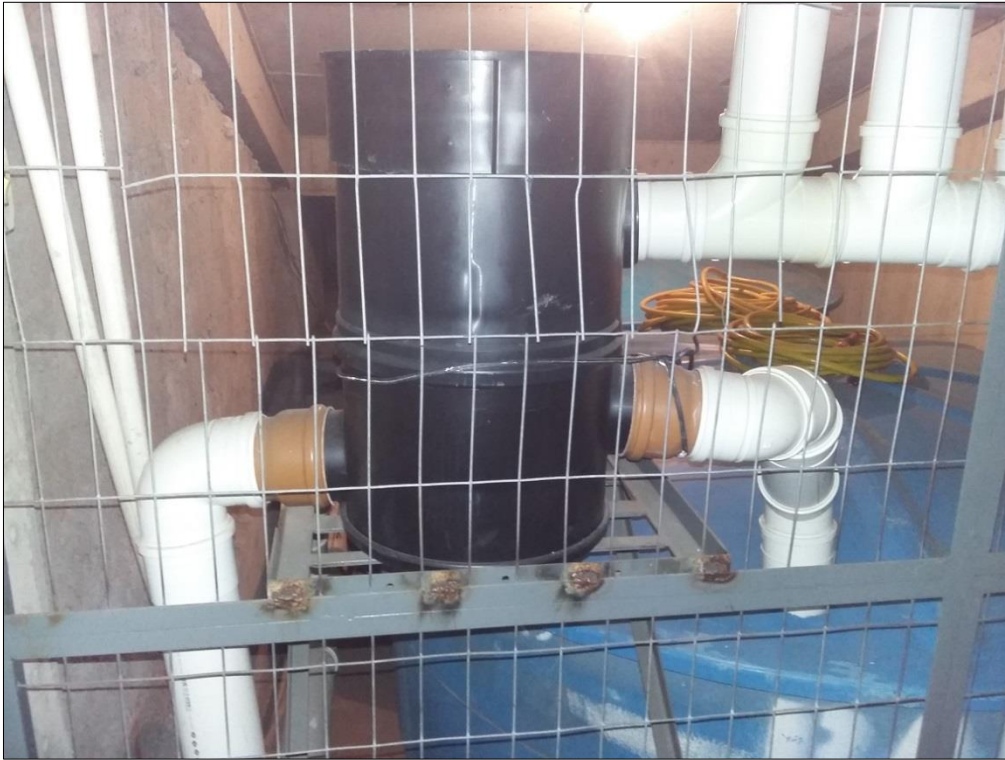
Figura 19 – Filtro do sistema de aproveitamento da água da chuva da edificação de estudo
