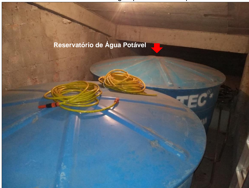
Figura 21 – Reservatório inferior de água potável com capacidade de 5.000 L
