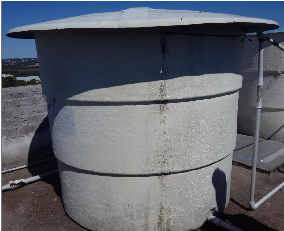
Figura 24 – Reservatório de água potável com capacidade de 3.000 L
