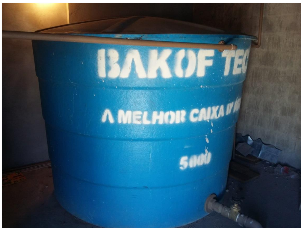
Figura 22 – Reservatório de 5.000 L de reserva de incêndio
