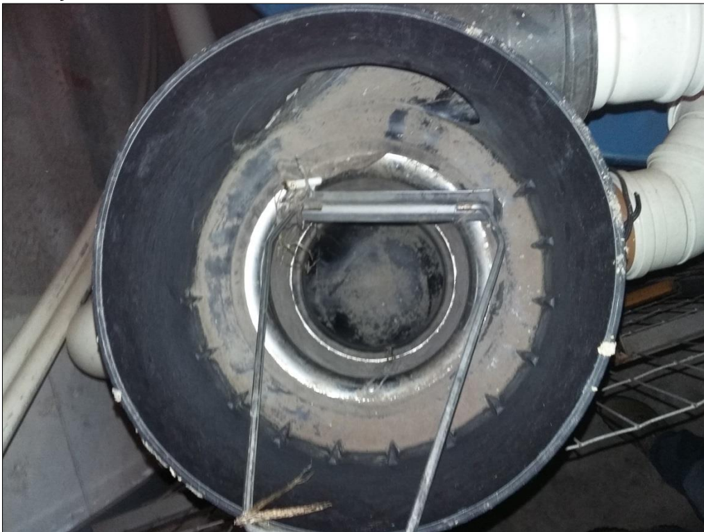
Figura 20 – Vista da parte interna do filtro do sistema de aproveitamento pluvial da edificação de estudo
