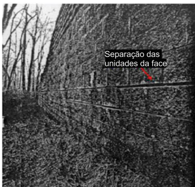
Figura 3.7 – Abaulamento visível e separação entre blocos da face.
