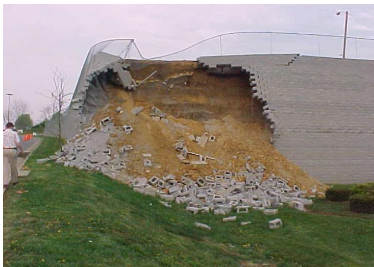
Figura 3.9 - Falha na ECSR no SW da Virginia mostra superfície de falha rasa atrás da face do muro.
