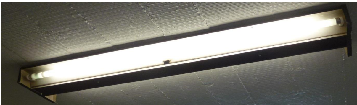
Figura 10: Exemplo de luminárias do sistema atual.
