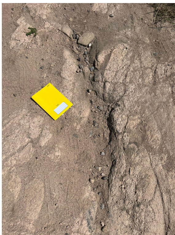
Figura 23- Rocha granito aflorante na estrada, expondo a erosão da própria rocha pela água que corre pela estrada. Ponto 03.
