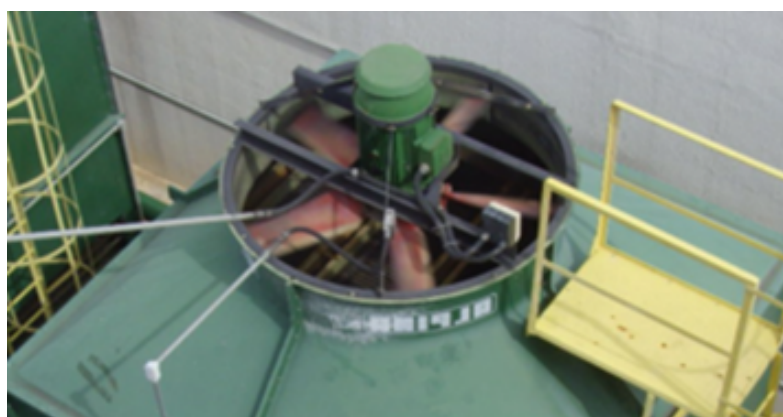
Figura 4 – Ventilador do tipo axial de uma torre de resfriamento
