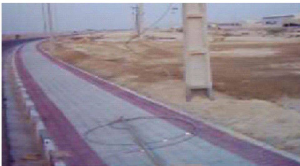
Figura 14 – Ocorrência de vários arcos em uma superfície de cimento.
