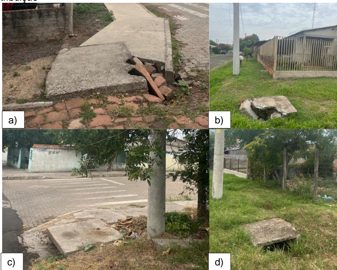
Figura 26 - (a, b, c, d) – Dispositivo de drenagem ‘boca-de-lobo’ da bacia de contribuição
