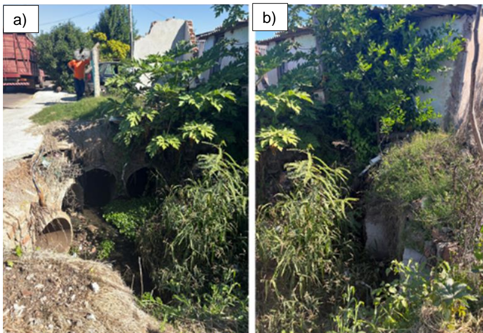
Figura 27 - (a, b) - Dispositivo de drenagem 'galeria' da bacia de contribuição
