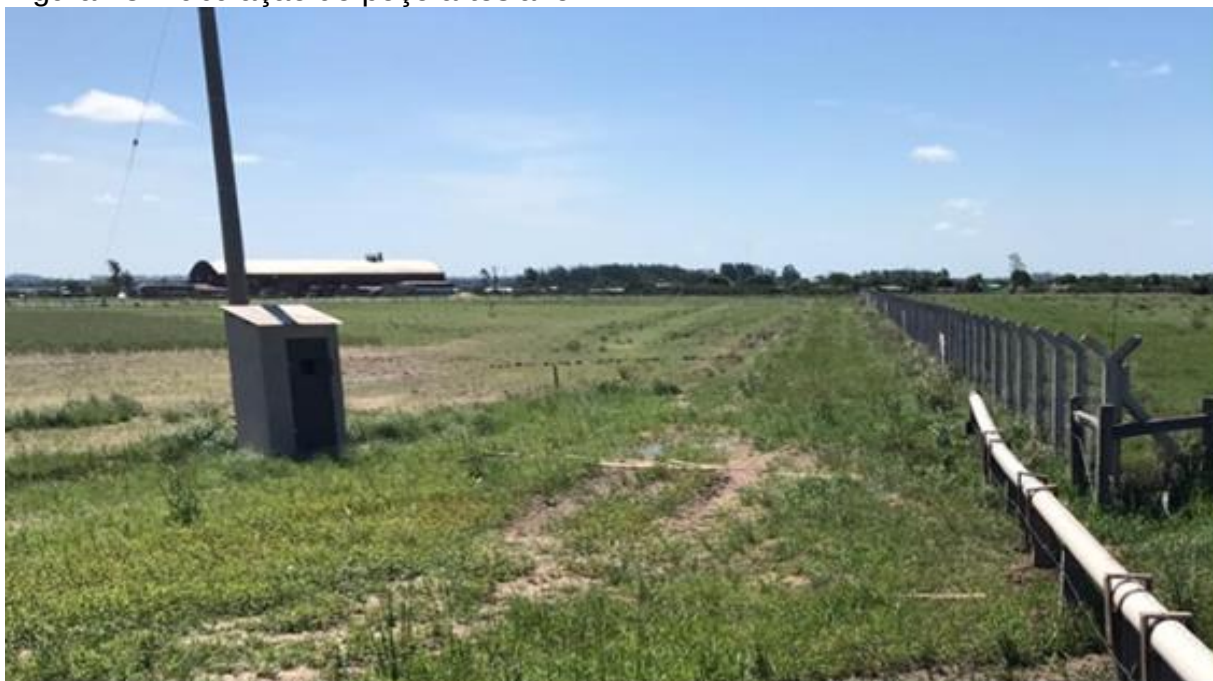
Figura 18: Tubulação do poço artesiano
