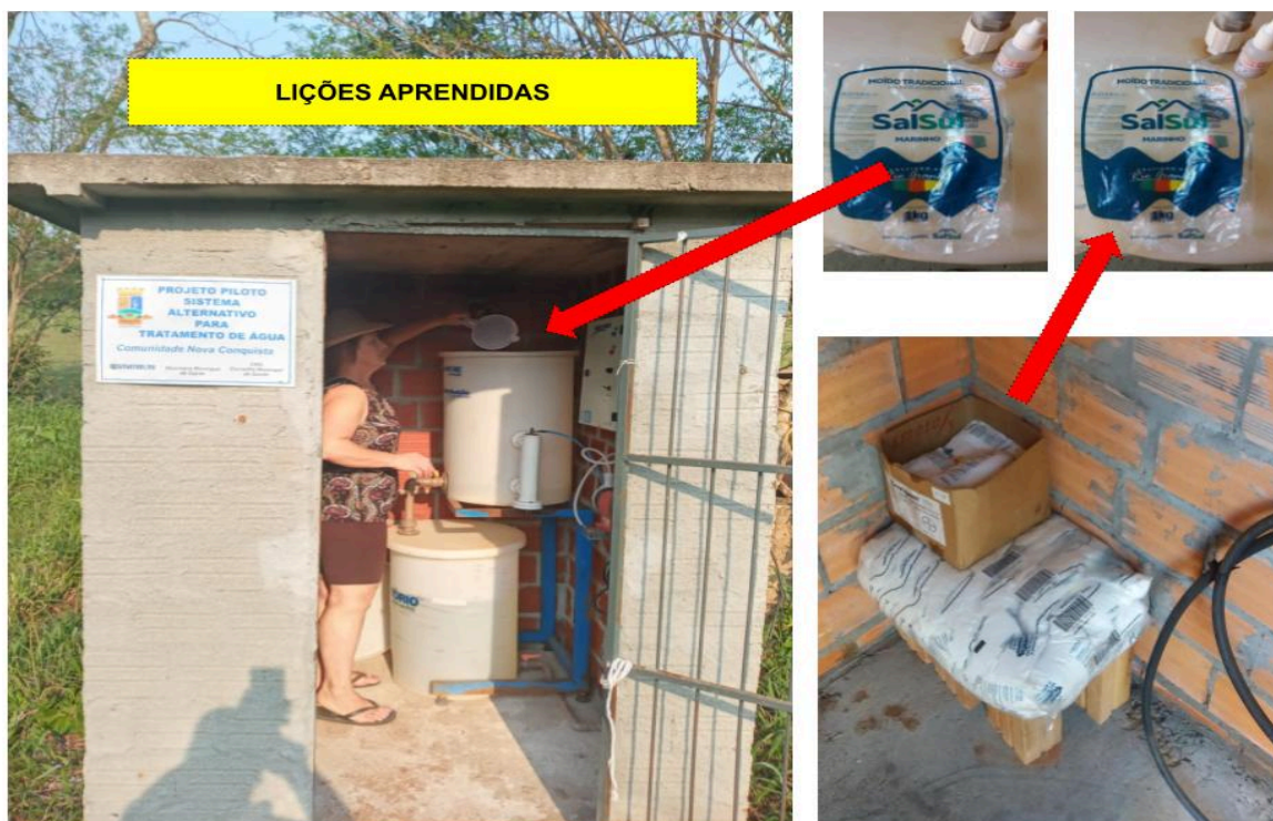
Figura 12. Sistema de tratamento alternativo de água.
