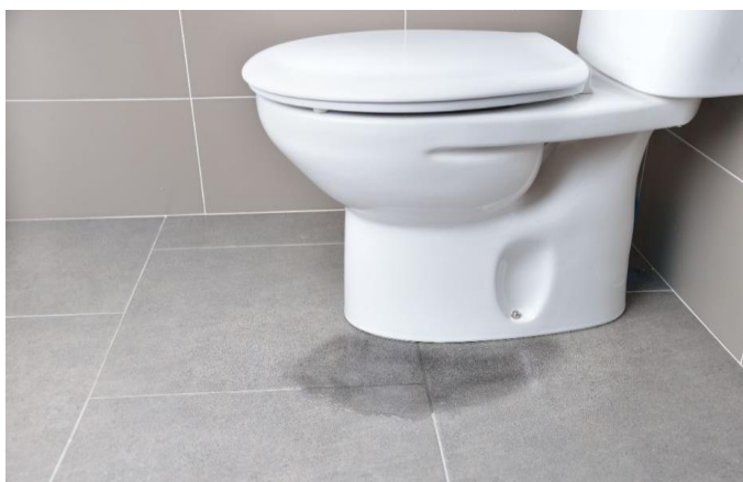
Figura 13 — Vazamento na base da bacia sanitária
