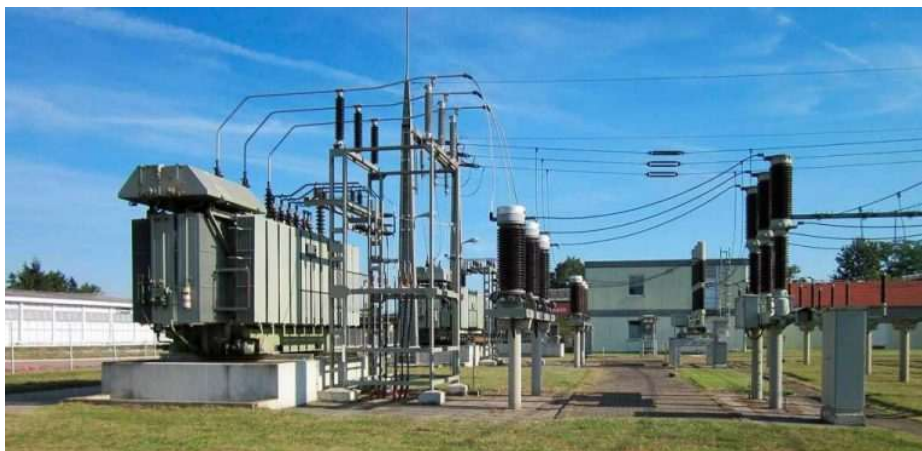
Figura 6 - Subestação ao tempo
