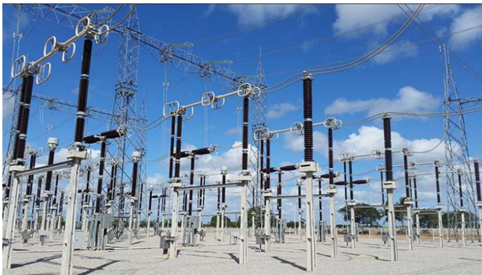
Figura 2 - Subestação de Manobra
