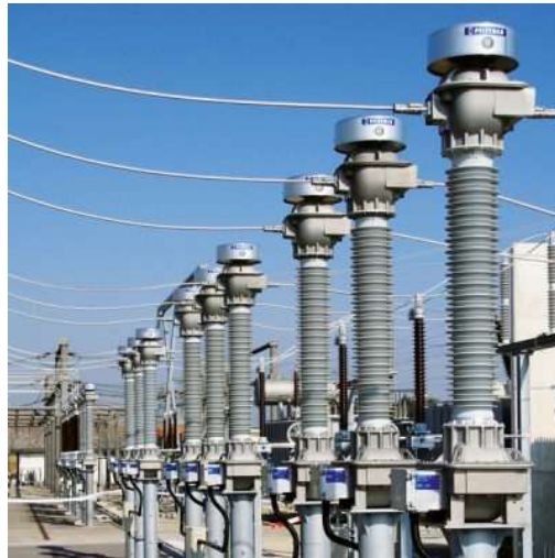
Figura 8 - Transformador de Corrente
