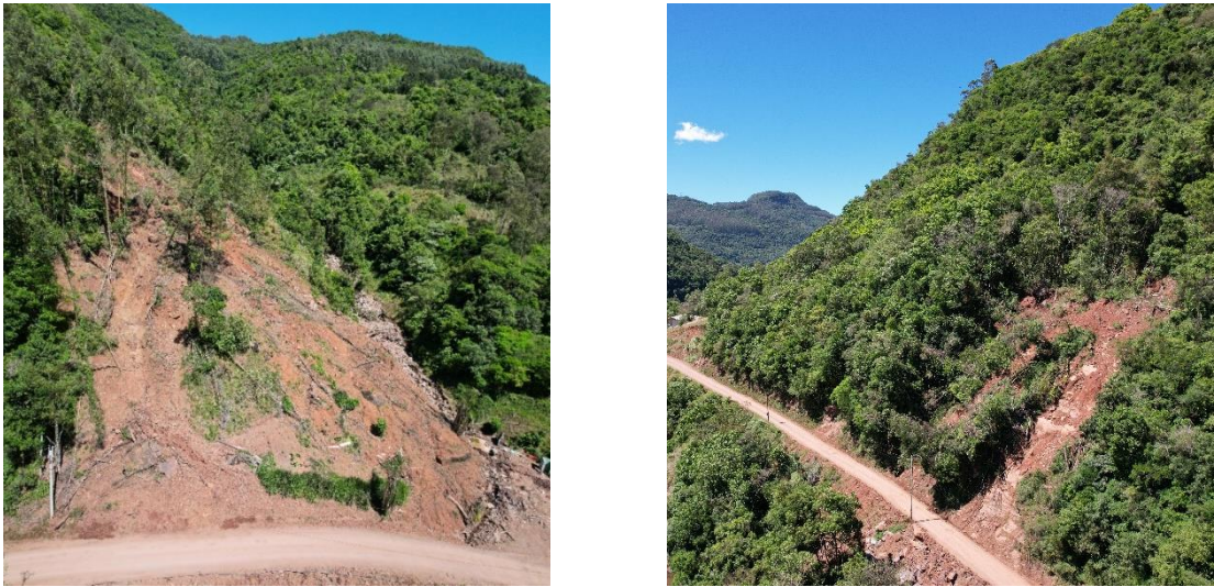
Figura 12 – Instabilidade em taludes da região.
