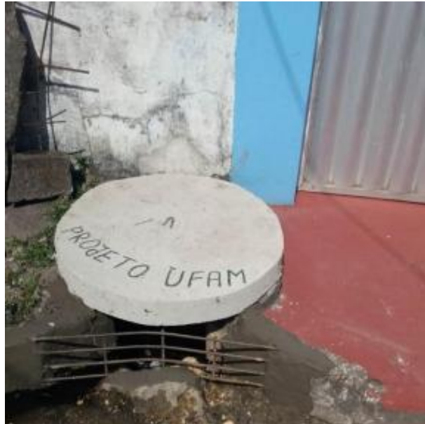
Figura 2 – Tampa de bueiro contendo resíduo de vidro
