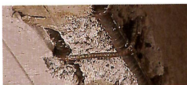
(a) Cobrimento inadequado das armaduras
