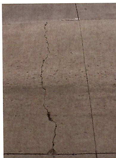
(c) Espaçamento inadequado de juntas
