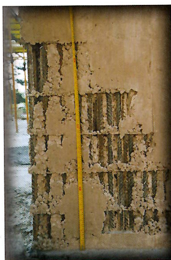
(b) Adensamento insuficiente
