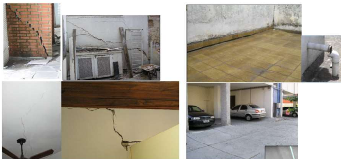
Figura 5 - Ilustração dos problemas ocorridos nas casas do Bairro Moema em São Paulo.
